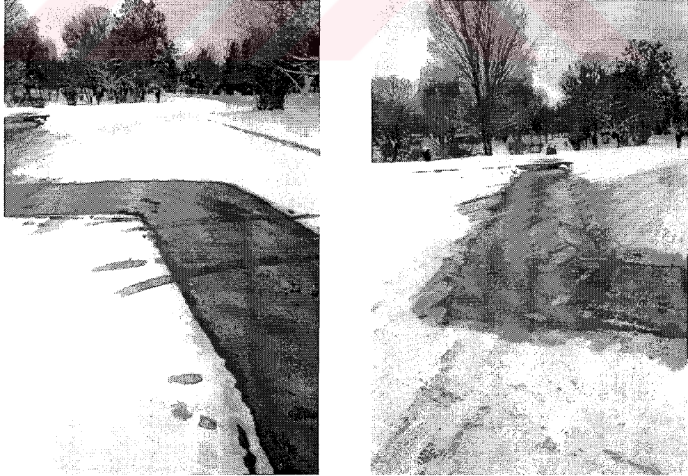
Şekil 5.2. Isı kaybından dolayı kanallar üzerinde karların erimesi (fotoğraf, karın yağmasından bir gün sonra çekilmiştir)
