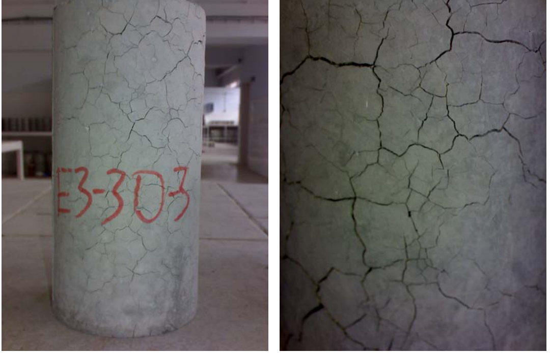
Şekil 4.3. Yangın sonrası beton yüzeyinde oluşan çatlaklar
