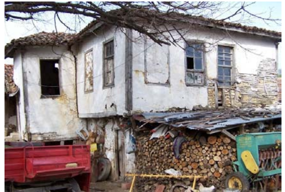
Resim 3.38. Dış cephede kireç harcı kaplama
