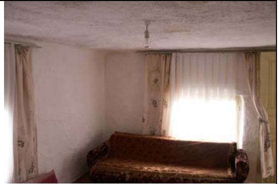
Resim 2. Yapının kireç badanalı tavan ve duvarı
