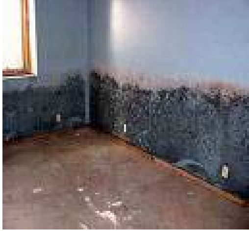
Resim 3.5 Yoğuşmanın Duvarda Oluşturduğu Hasar (Evyapan, 2006)
