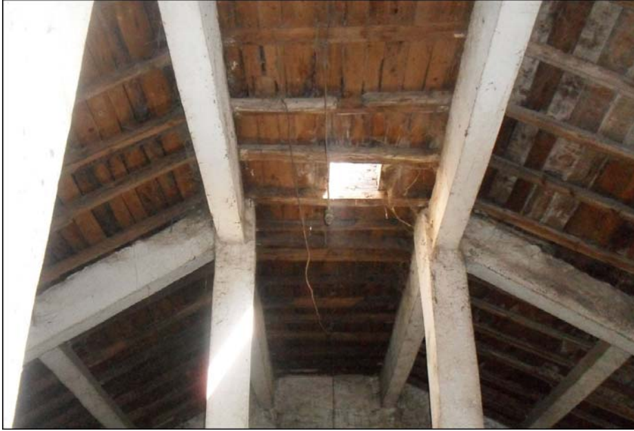
Şekil 4.3. Aşkale süt sığırı işletmesi çatısına açılan havalandırma bacası
