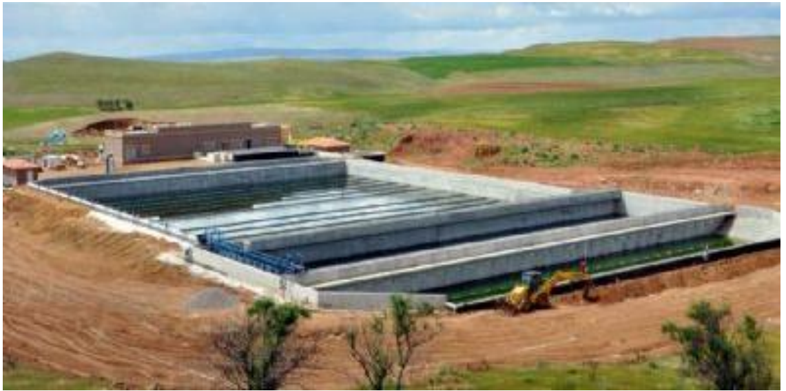
Şekil 4.55. Kırşehir Belediyesi AAT
