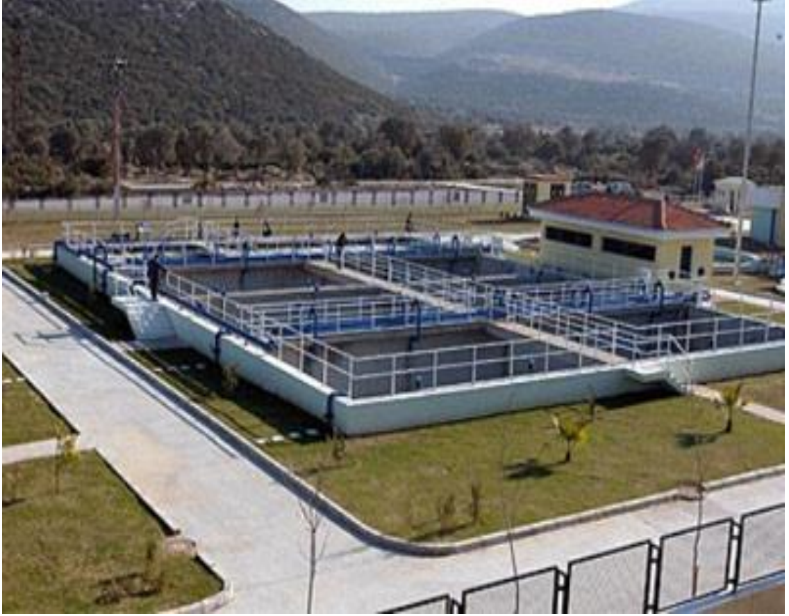
Şekil 4.34. İzmir Yüksek Teknoloji Enstitüsü atıksu arıtma tesisi
