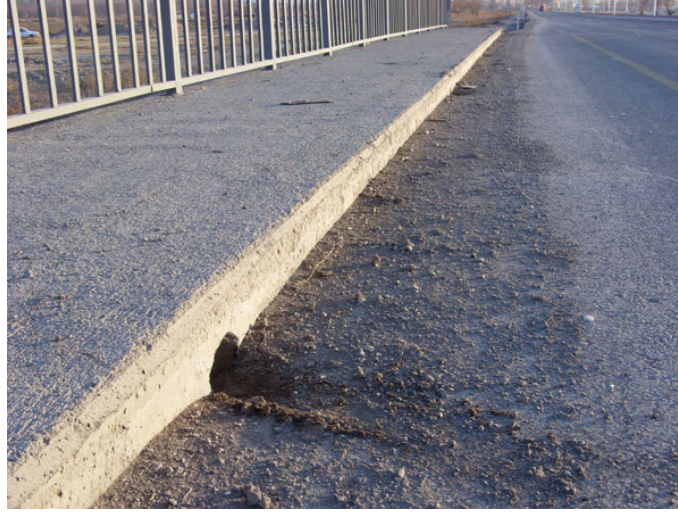
Şekil 3.31. Köprü Üzerinde Garguy Çukuru ve Korkuluk.
