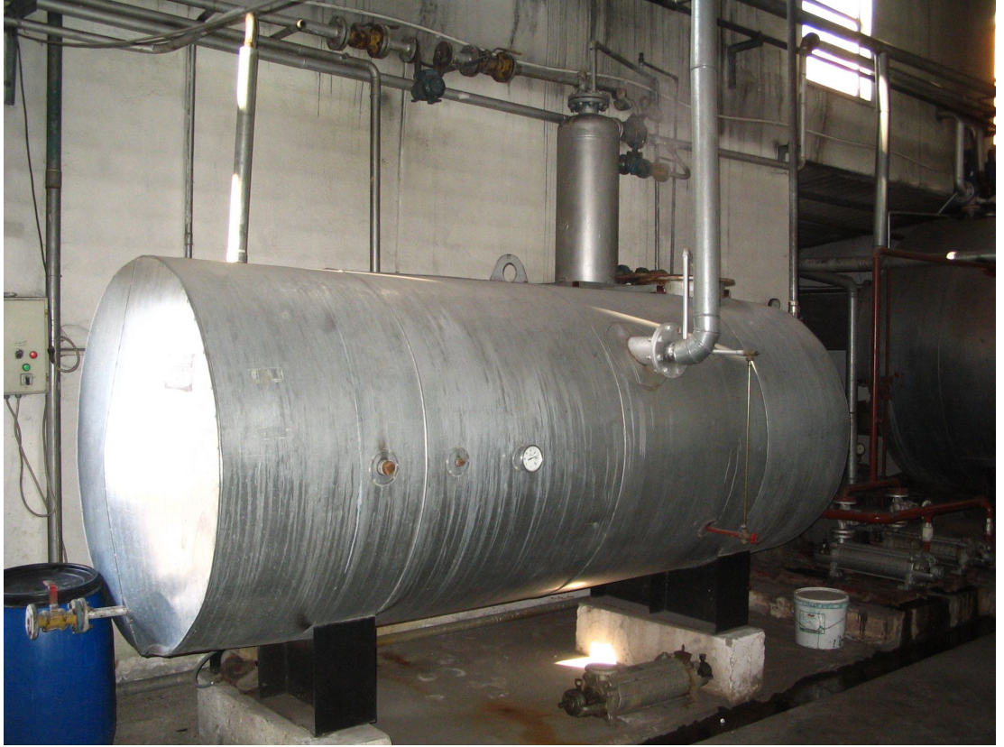
řekil 3.11. Tanklardan bazıları (kondens tankı).
