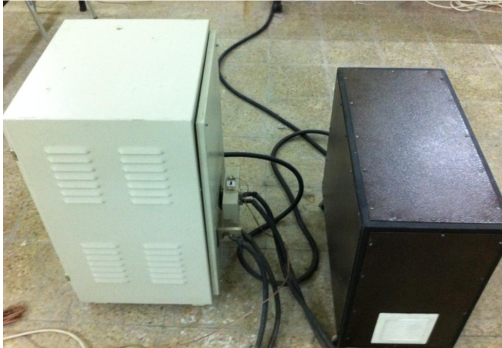
Şekil 4.2. Isıtma için kullanılan transformatör ve varyak.
