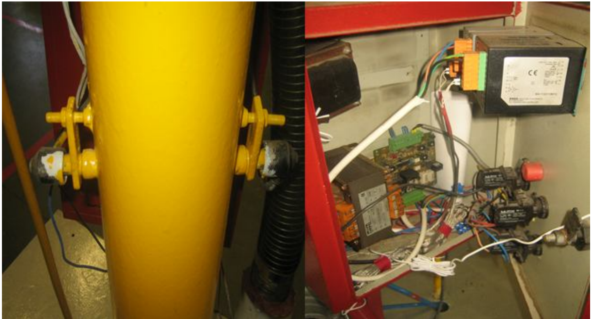
Şekil 4.6. Yanma odası üzerine monte edilmiş ateşleme bujileri ve Trafo
