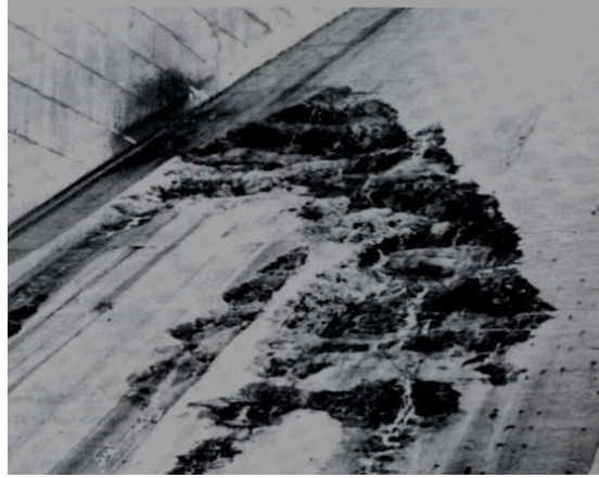
Şekil 2.6. Baraj dolusavağında kavitasyon
