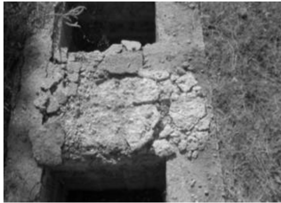
Şekil 2.7. Betonda donma-çözülme hasarı
