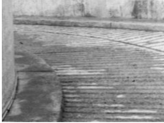
Şekil 2.4. Otoyol rampasında aşınma
