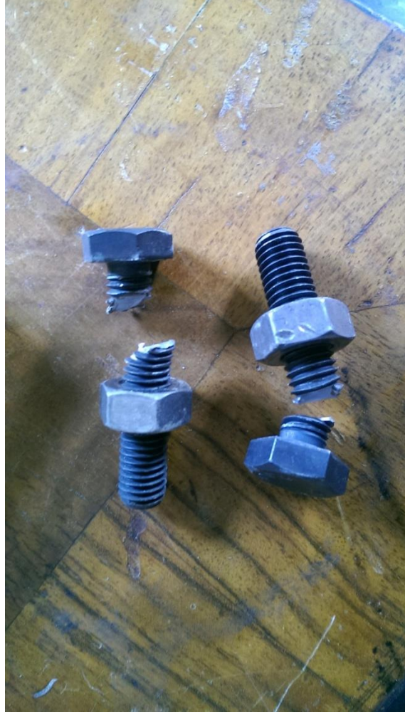
Şekil 4.21. Birleşimin üst bölgesinde meydana gelen cıvata kırılmaları
