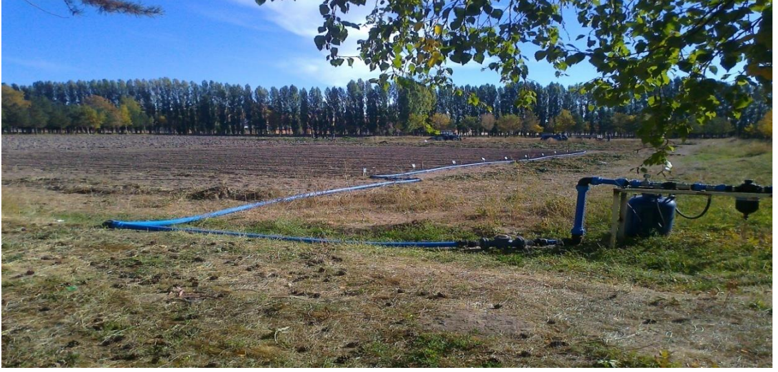
Şekil 3.20. Deneme alanı: damla sulama sistemi basınç ünitesi
