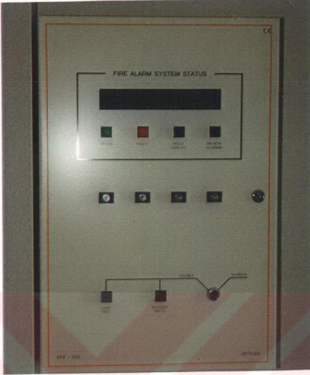
Resim 3: Yangın alarm sistemi; her katta hemşire istasyonu yanında bulunmaktadır.
