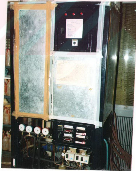
Şekil 11. Klima santralinden bir görünüş.
