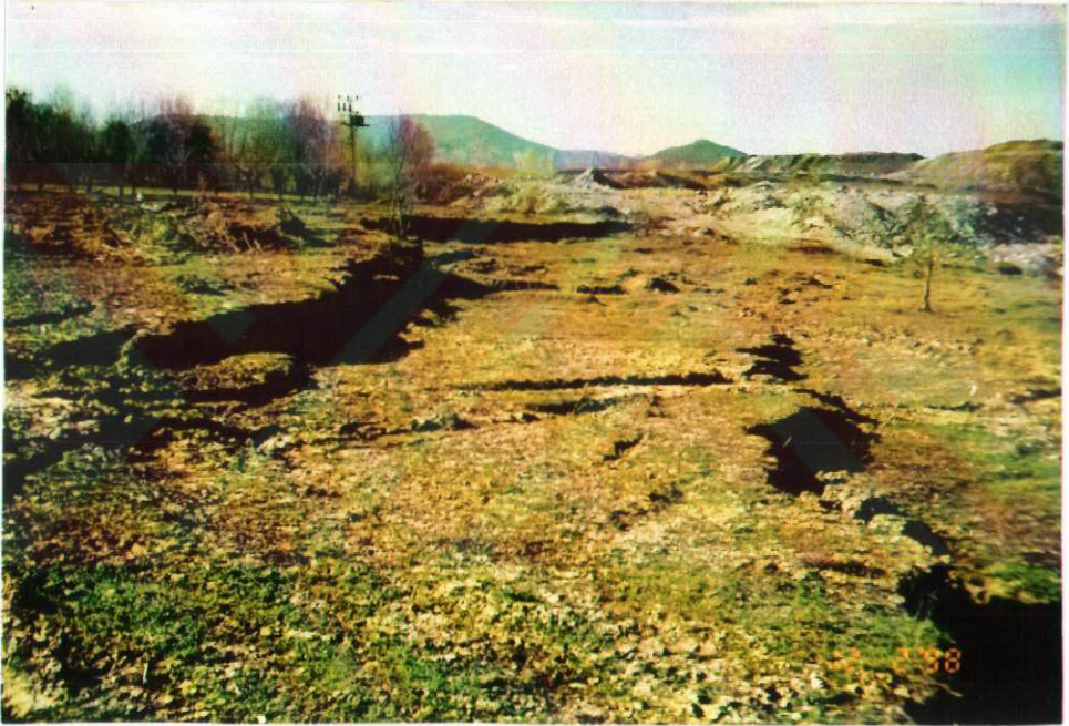
Şekil 5.9: Güney şevinin üst kotlarında alüvyonda gelişmiş tansiyon çatlakları ve oturmalar
