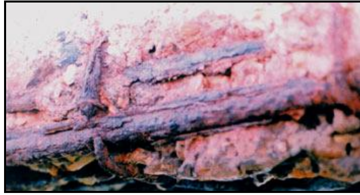
Şekil 1.10. Aderansı tamamen engelleyen ileri derecede korozyonlu kiriş donatılarından bir görünüm [43].
