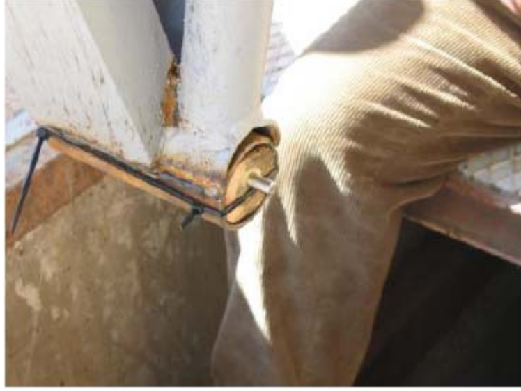
Resim 2. Altakiş kısmı termometrelerinin vibrasyondan etkilenmeyecek şekilde yerleştirilmesi
