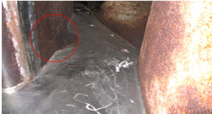
Resim 1. Keban Hidroelektrik Santralında bir türbin çarkının aşınmaya uğramış bölgesi
