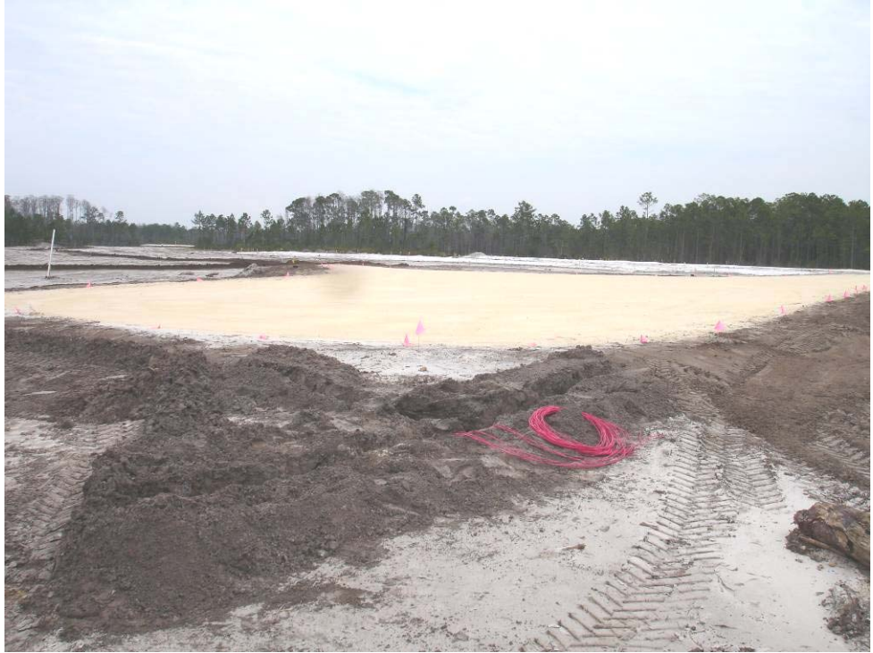
Şekil 4.17 Amick'in tasarladığı sahadan alt yapı ve kablolama (Orijinal 2007)
