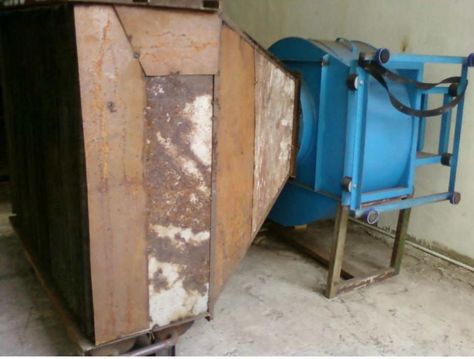
Şekil 25. Isıtıcı serpantine bağlanmış fan ünitesi
