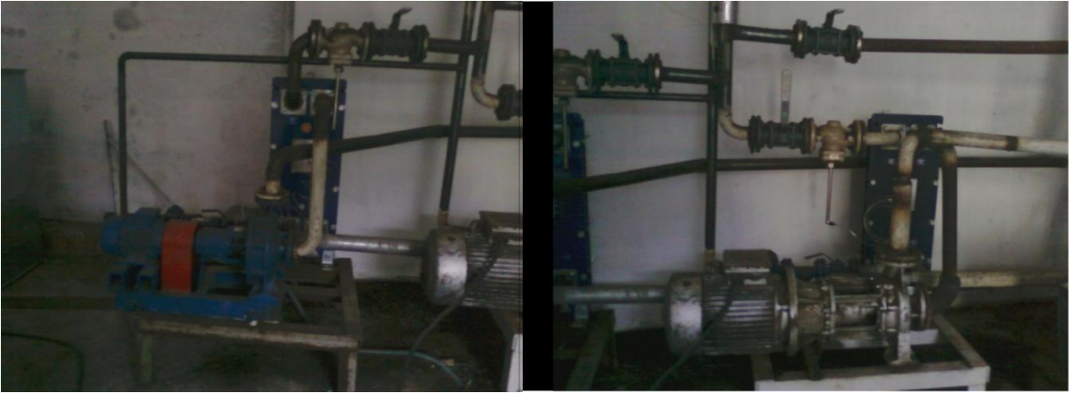
Şekil 30. Eşanjör ve Pompa Sistemi
