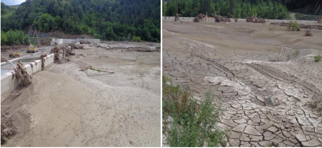
Şekil 13. 2012 Yılında Meydana Gelen Sel Sonucu Hasara Uğrayan HES İnşaatı
