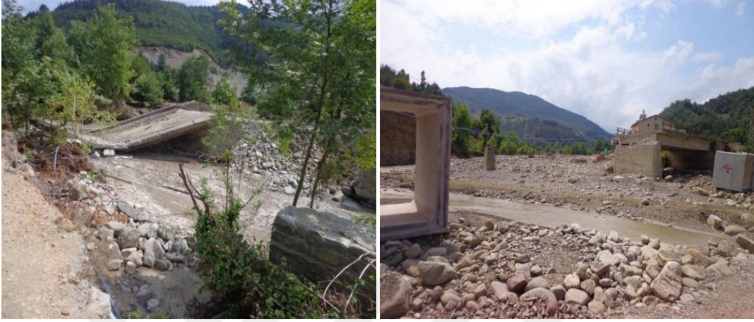
Şekil 15. Sel Hadisesiyle Yıkılan Köprüler
