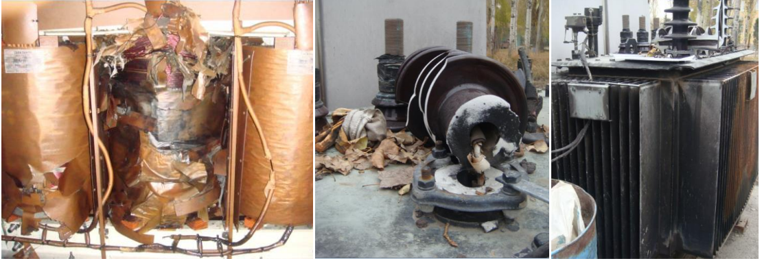
řekil 12. Trafo Yangını
