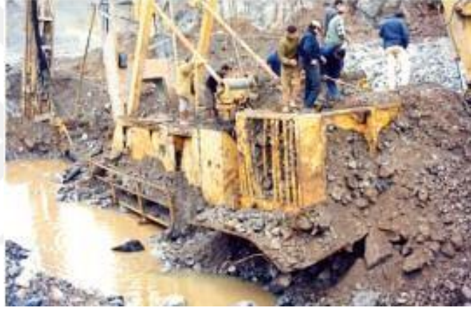
Şekil 18. Hidroelektrik Santrali İnşaatında Sel Sonrası Rüsübat Birikimi
