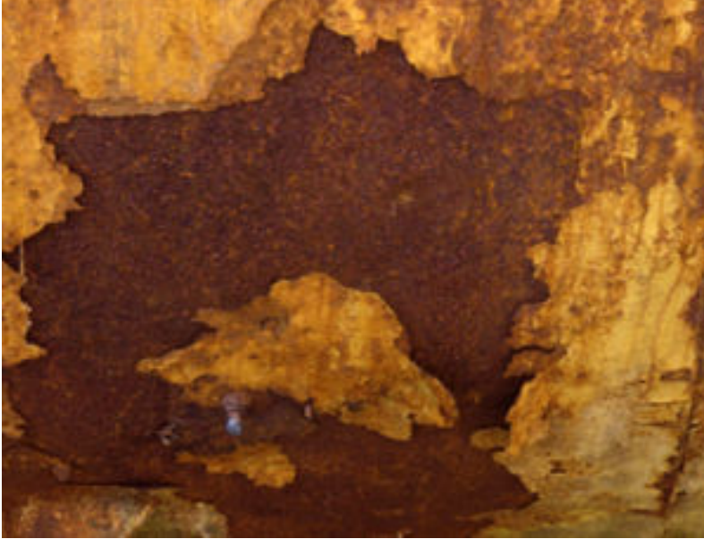
Şekil 2.1. Korozyona uğramış metal yüzey
