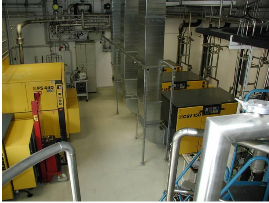
Şekil 5.5 ELBE Laboratuvarında kullanılan kompresörler
