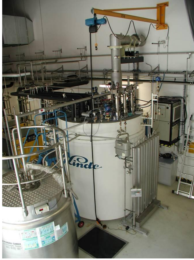
Şekil 5.4 ELBE Işınım Tesisinde kullanılan soğutucu kutu ve transfer hattı
