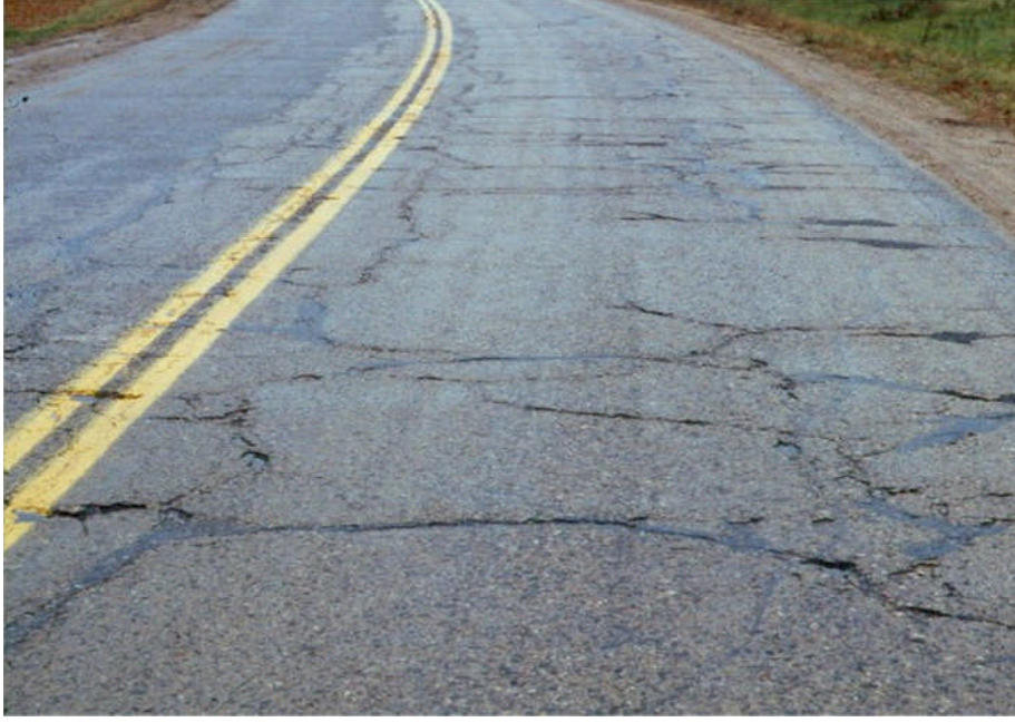
Şekil 4. Asfalt kaplama tabakasında meydana gelen yorulma çatlakları
