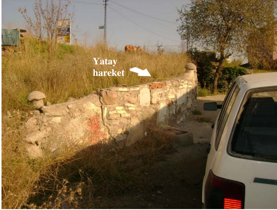
Şekil 4.2. Örnekleme alanındaki bir bahçe duvarında yanıl yöndeki şişmeye bağlı olarak gelişen kavislenme (3 no.lu örnekleme yeri, Yüzüncüyıl Mahallesi).
