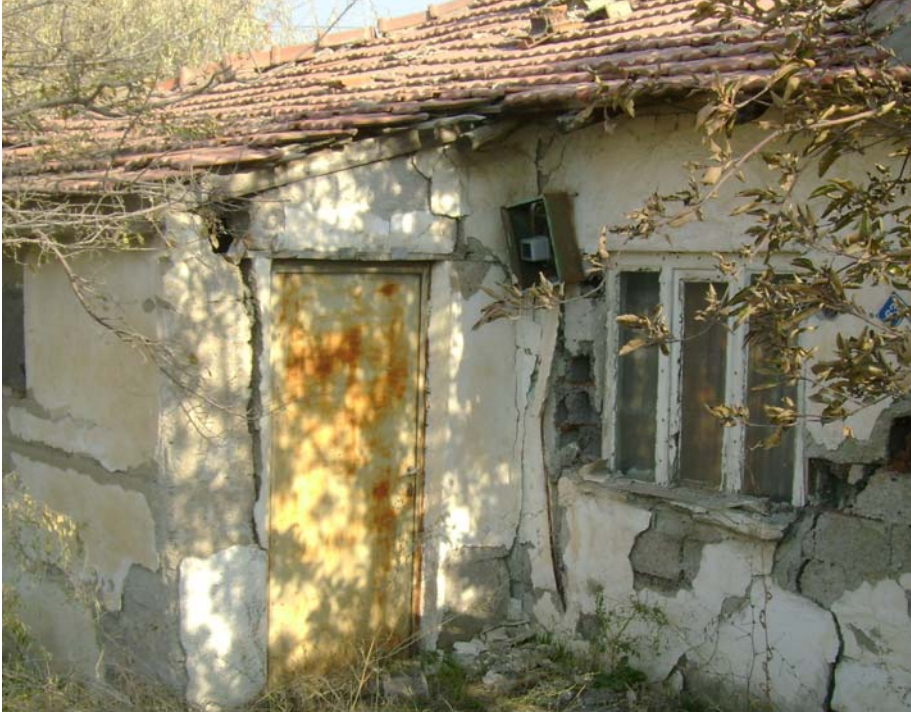
Şekil 4.1. İnceleme alanındaki gecekondü duvarlarında zemindeki şişmeye (kabarmaya) bağılı olarak gelişmiş çatlaklar (6 no.lu örnekleme yeri, Öveçler 2. Cadde).
