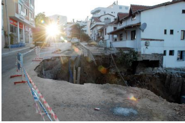
Şekil 3.1. Düzce Akçakoca’da meydana gelen temel kazısının göçmesi.
