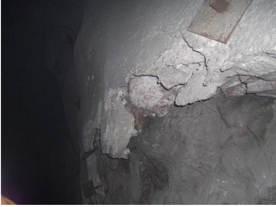
Şekil 1.21. Kırılmış beton tahkimat
