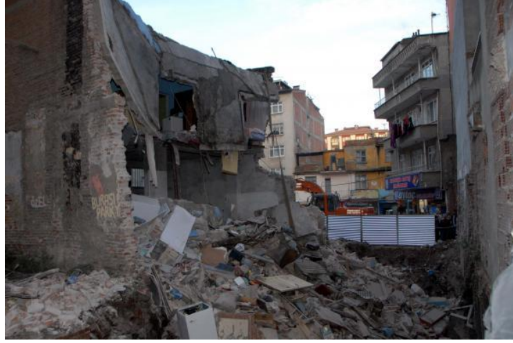
Şekil 3.2. Samsun Bafra’daki binanın çökmesi
