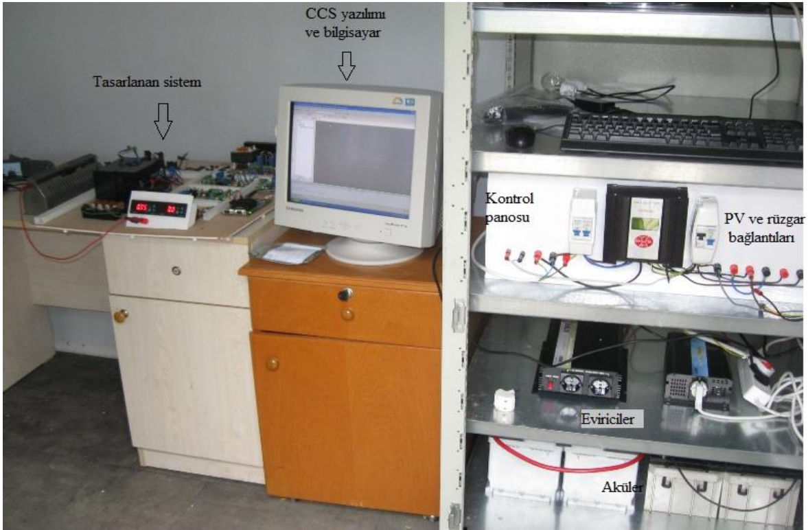
Şekil 155. Temiz enerji evinin içinde kurulan çevirici sistem ve enerji kabini
