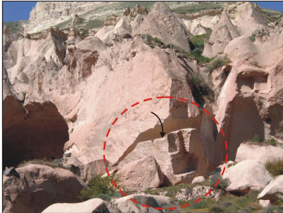
Şekil 5.3. Zelve 1. Vadi'de topuk desteğinin yitimi sonucu bloğun yerçekimi etkisi altında düşmesi şeklinde gelişen bir duraysızlık.
