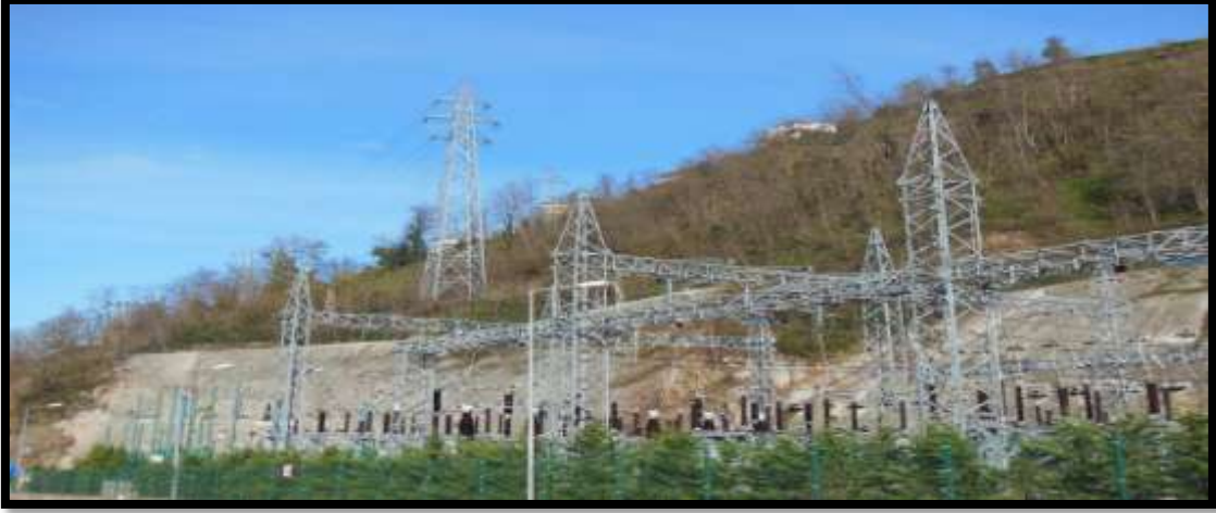
Şekil 22. Kalkandere HES şalt tesisi (17.12.2015)
