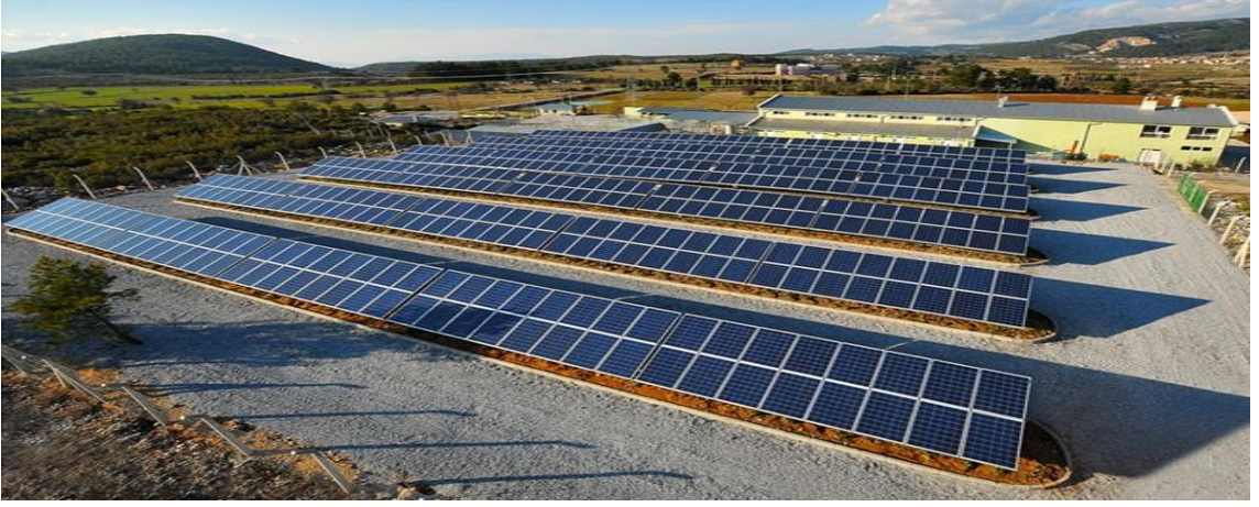
Şekil 6. Fotovoltaik güneş enerjisi paneli
