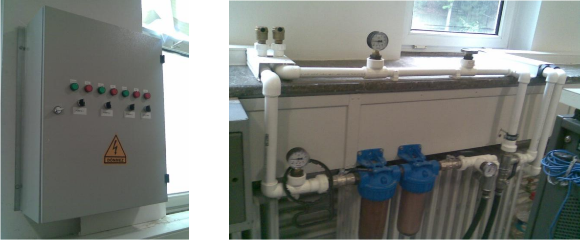
Şekil.2 Elektrik güç panosu ve cihaz giriş-çıkışlarında kurulu sistem
