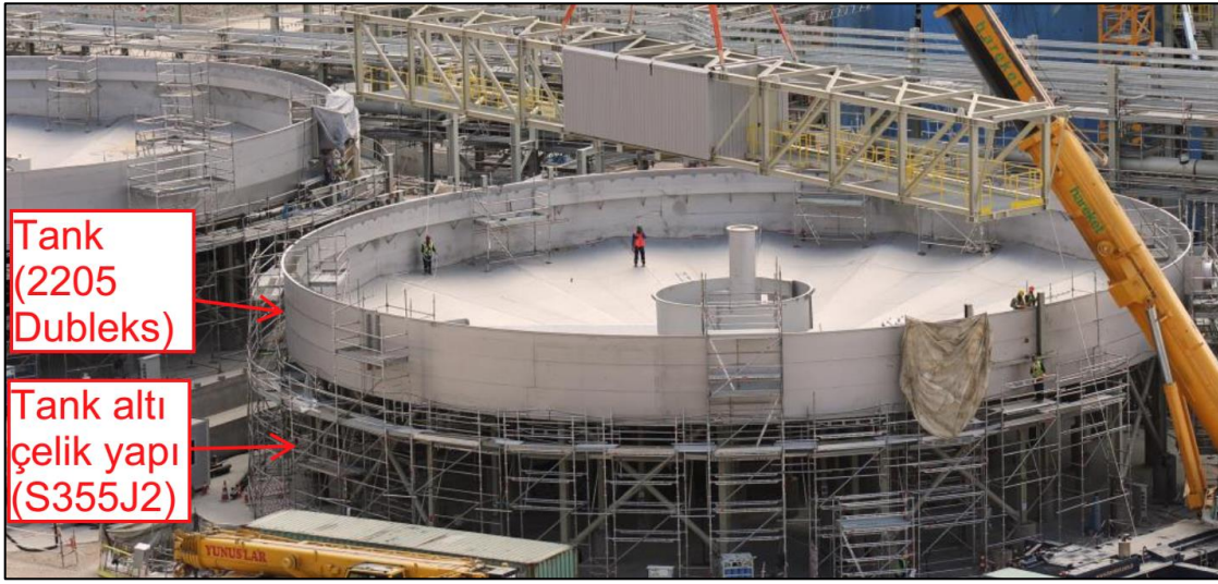
Şekil 10. 35m çapında tikiner tank. Tank 2205 dubleks paslanmaz çelik, tank altı çelik yapı S355J2 genel yapı çeliği [49].
