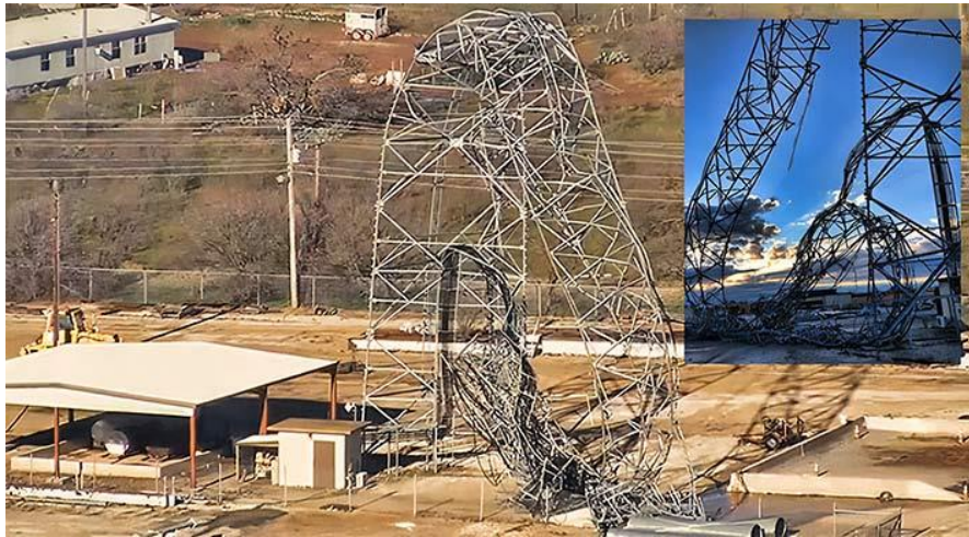
Şekil 22. Rüzgâr etkisiyle yıkılan çelik kule. (URL-12, 2019)
