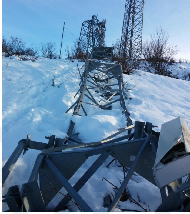
Şekil 21. Rüzgâr ve kar etkisi nedeniyle yıkılan kafes tipi çelik kule
