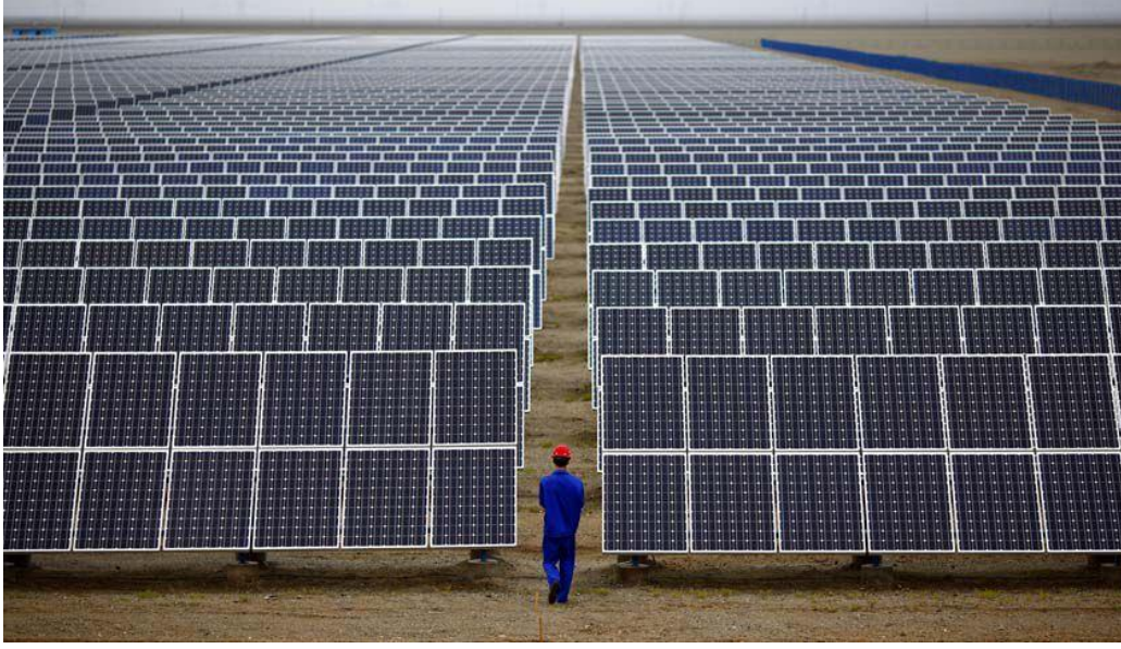
Şekil 2.3: Fotovoltaik güneş panellerinden oluşan bir güneş enerji santrali.
