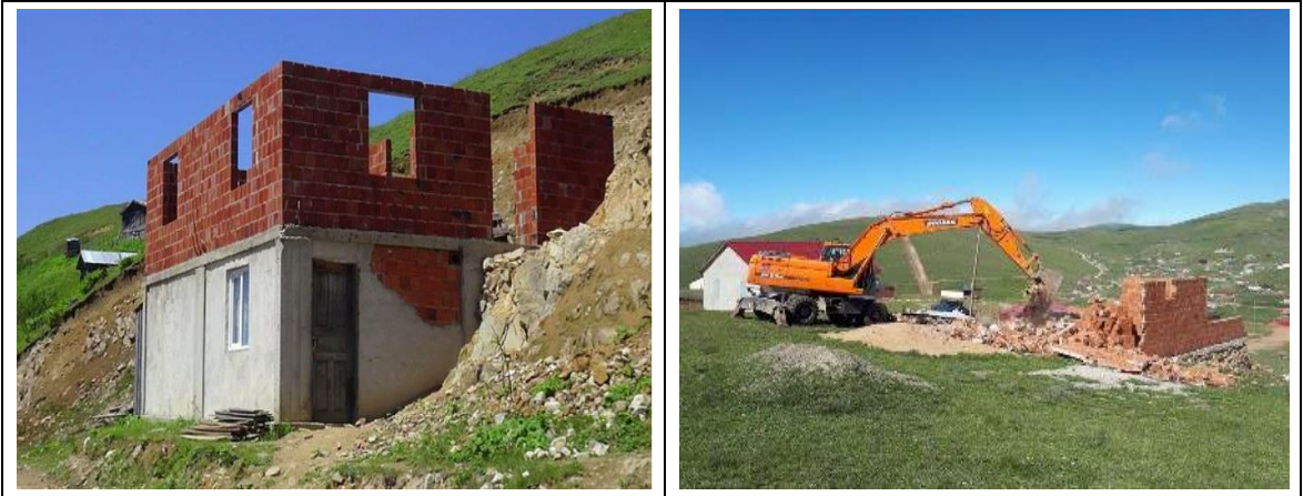
Şekil 2. Kırsal alanda kaçak yapılaşma ve yıkım işlemleri[URL-4].
