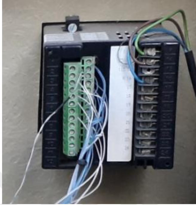
Şekil 3.6. Termokuplların bağlanıp sıcaklık ölçümünün yapıldığı data logger
