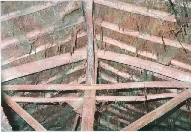
Şekil 4.6. Ahşap çatı elemanlarında görülen nem yoğunlaşması ve deformasyon
