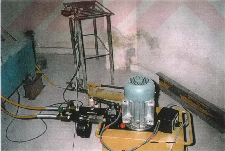
Şekil 4.14. Elektrikli pompa ve vanalar
