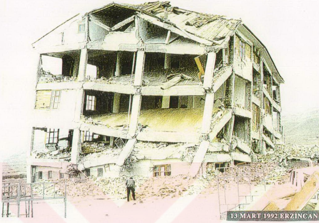
Şekil 1.2. Kolon kiriş birleşim bölgesi hasarı(Erzincan 1992)
