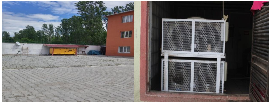
Şekil 4.16. İşletmelerde kullanılan jeneratör örnekleri.
