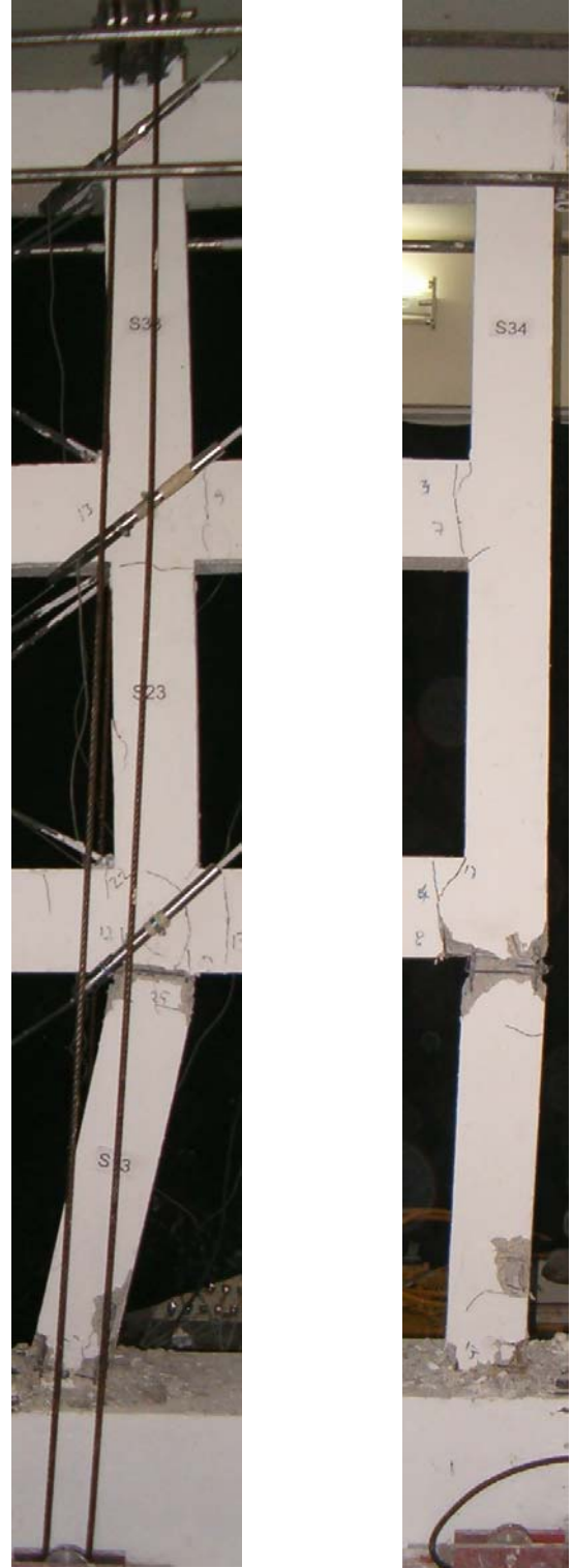
Şekil 5.3.5 Mesnetlerin ve zemin kat kolonlarında oluşan mafsallaşmalar
