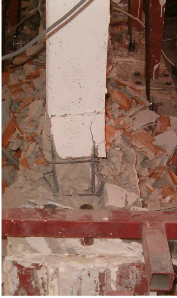
Şekil 5.10.11 10 nolu deney numunesinde dış kolon tabanında ezilme
