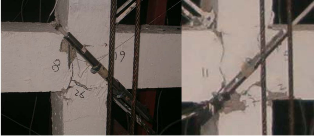
Şekil 5.5.6 5 nolu deney numunesinin orta kolon üstünde mafsallaşma
