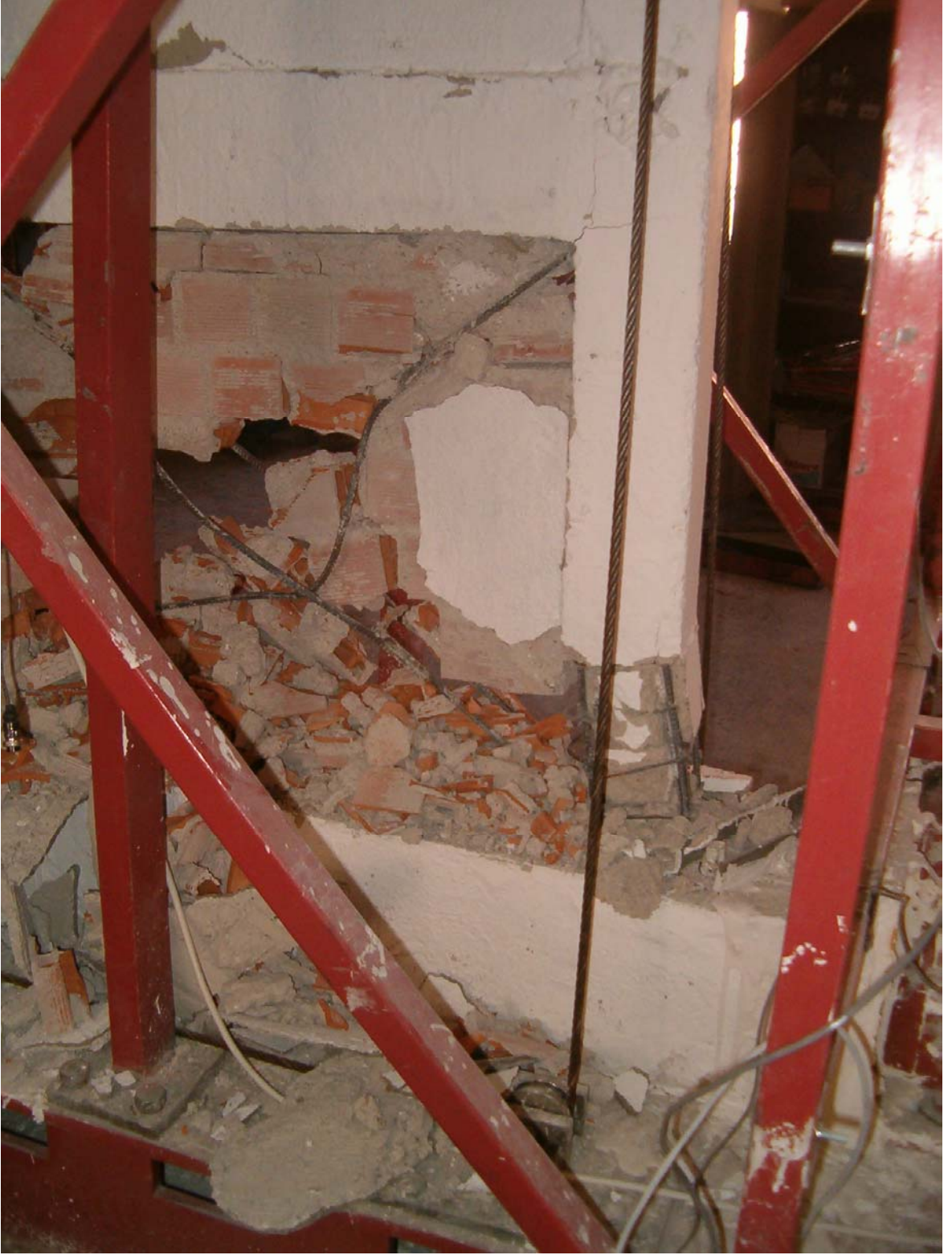
Şekil 5.10.4 Deney sonunda ezilmiş duvar ve kolon
