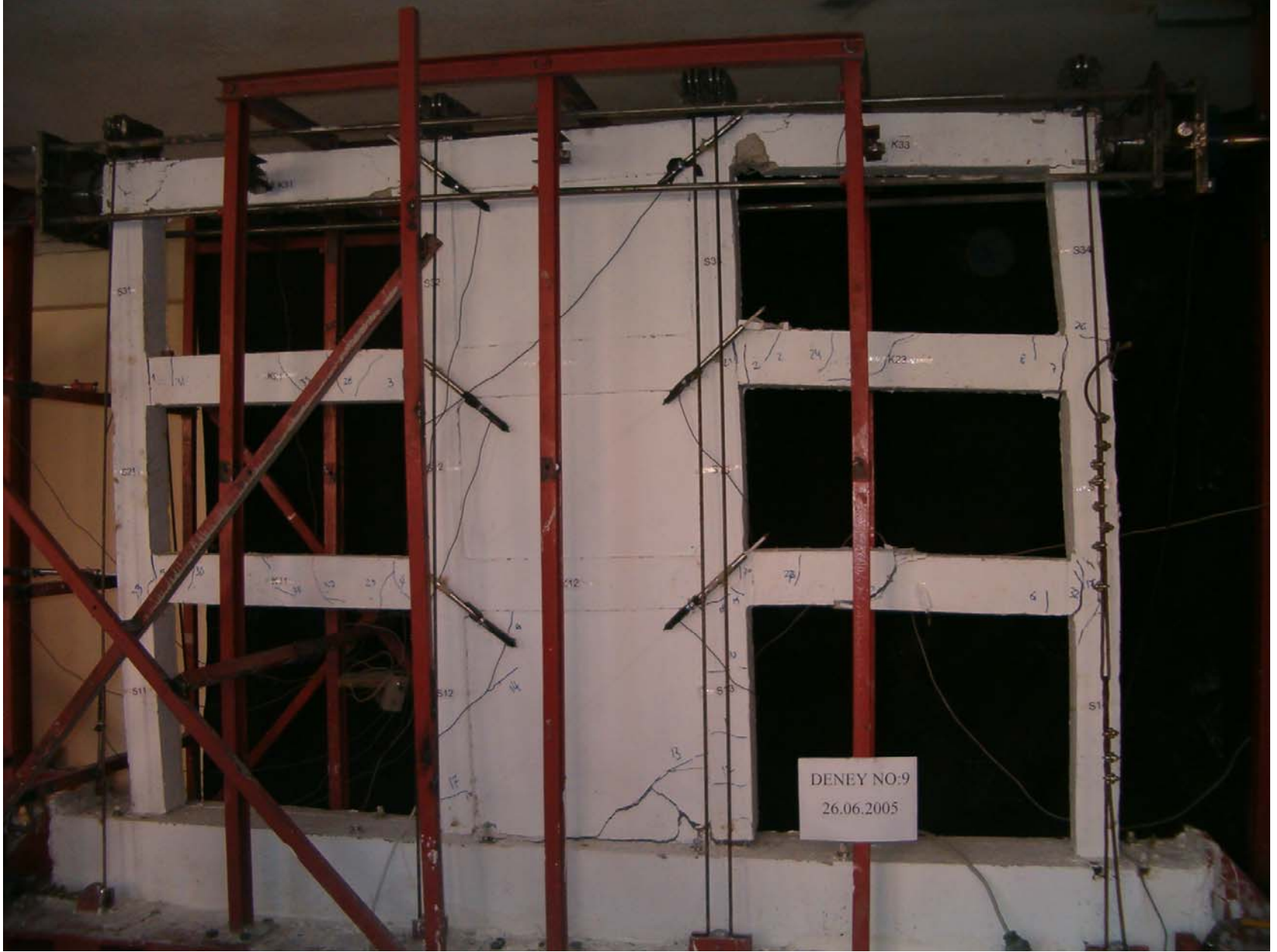
Şekil 5.9.2 9 nolu deney sırasında oluşan çatlaklar
