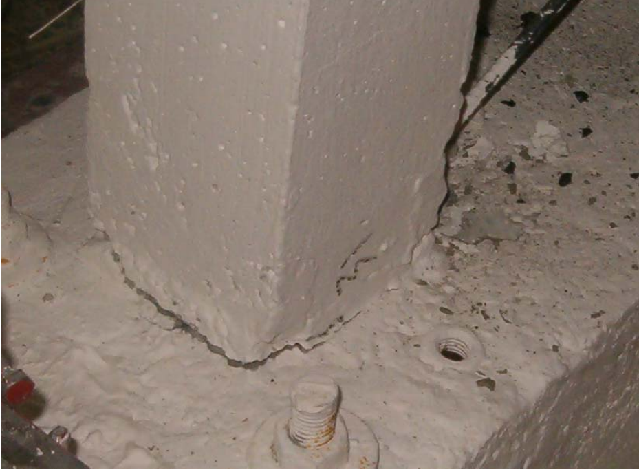
Şekil 5.7.11 7 nolu deney numunesinde kolon ile temel arasında açılma
