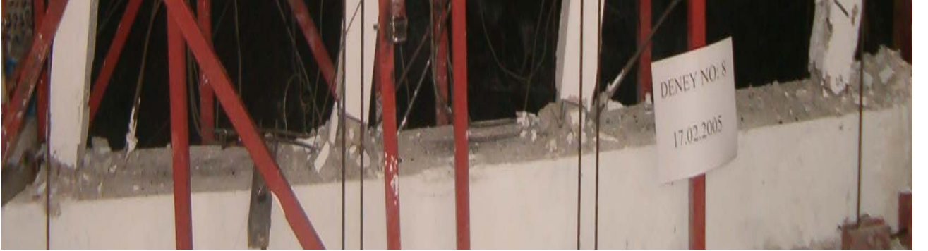
Şekil 5.8.12 Kolon tabanında ezilmeler
