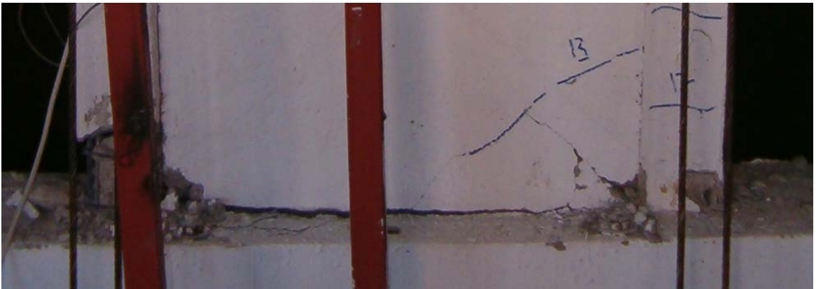
Şekil 5.9.12 Kolon tabanında ezilmeler ve ayrılmış dolgu duvar
