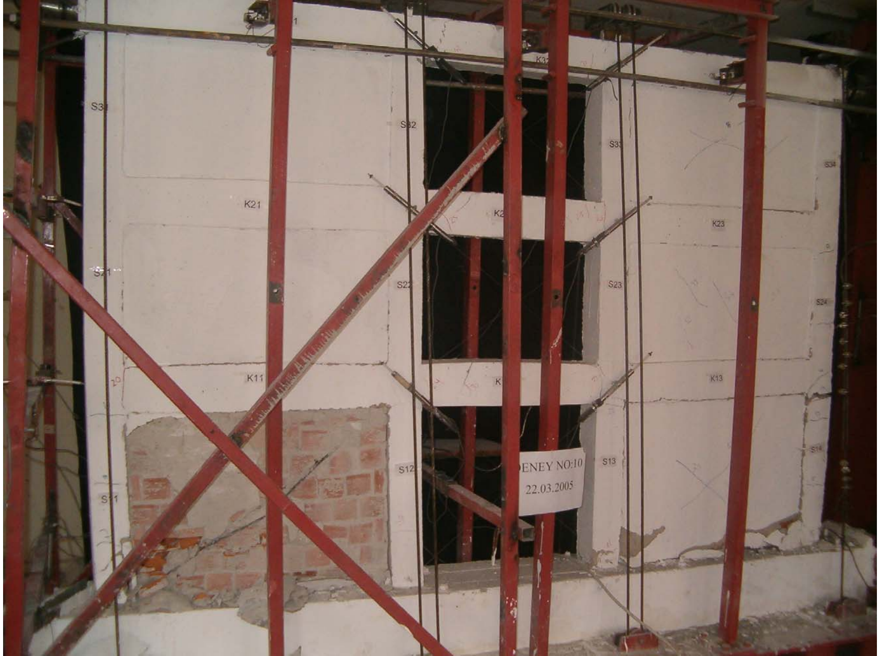
Şekil 5.10.2 10 nolu deney sırasında oluşan çatlaklar
