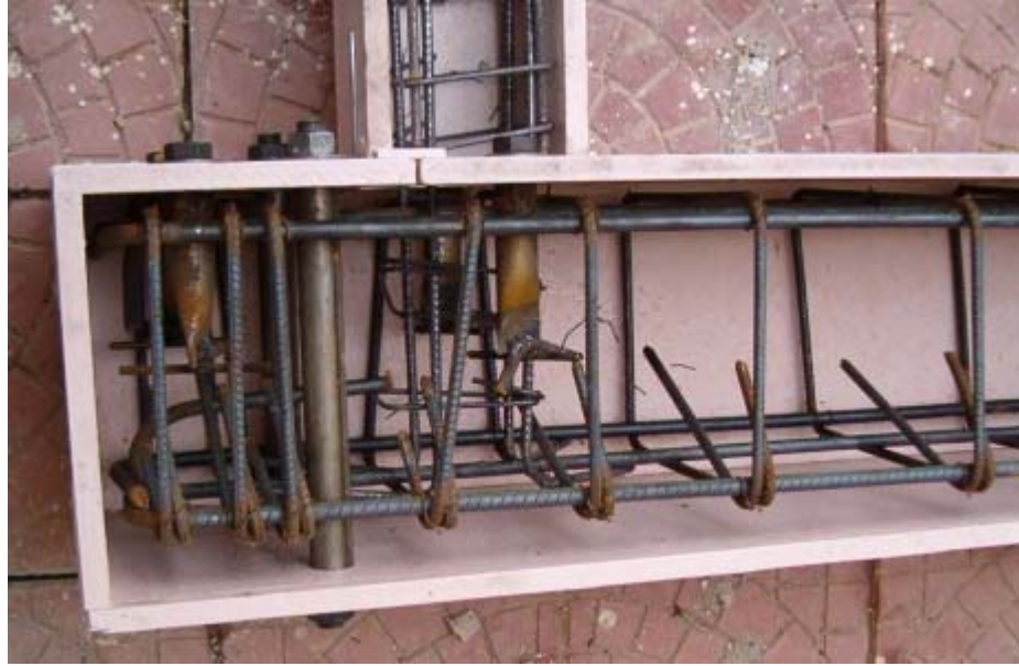
Şekil 3.28 Yatay konumdaki deney numunelerini kaldırma ve yatay olarak taşıma için kalıba eklenen parçalar
