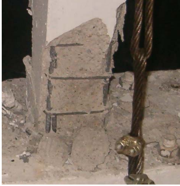
Şekil 5.4.8 4 nolu deney çerçevesi sağ kolon altında mafsall oluşumu
