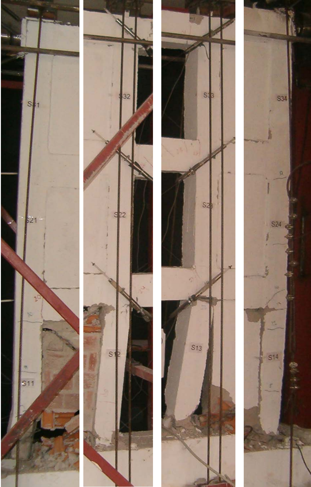
Şekil 5.10.7a Mesnetlerde ve zemin kat kolonlarında oluşan mafsallar
