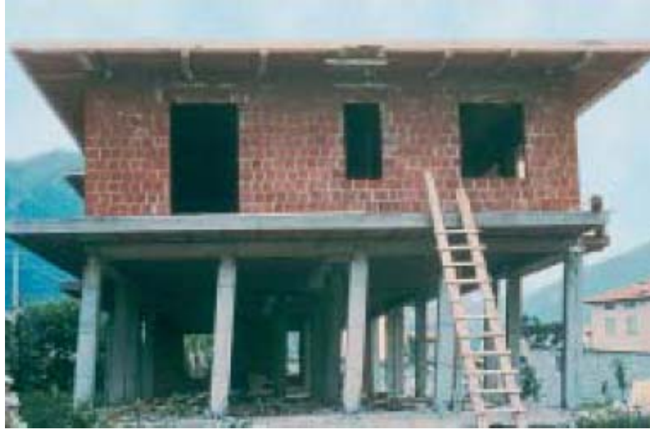
Şekil 1.3 Yumuşak kat mekanizması sonucu yıkılmış bina (İtalya 1976)
