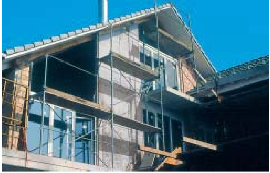
Şekil 1.13 Perdeler ile güçlendirilmiş 3 katlı bina (İsviçre 2001)
