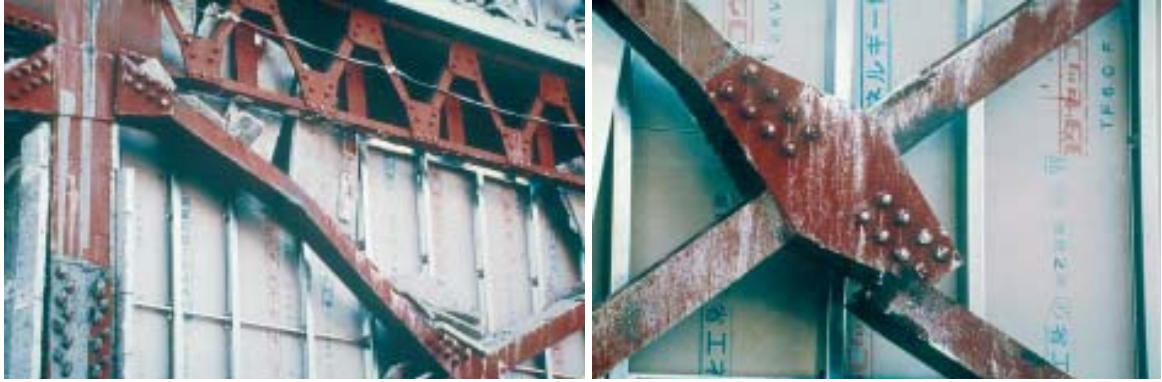
Şekil 1.16 Basınç çubuğunda hasar oluşumu
