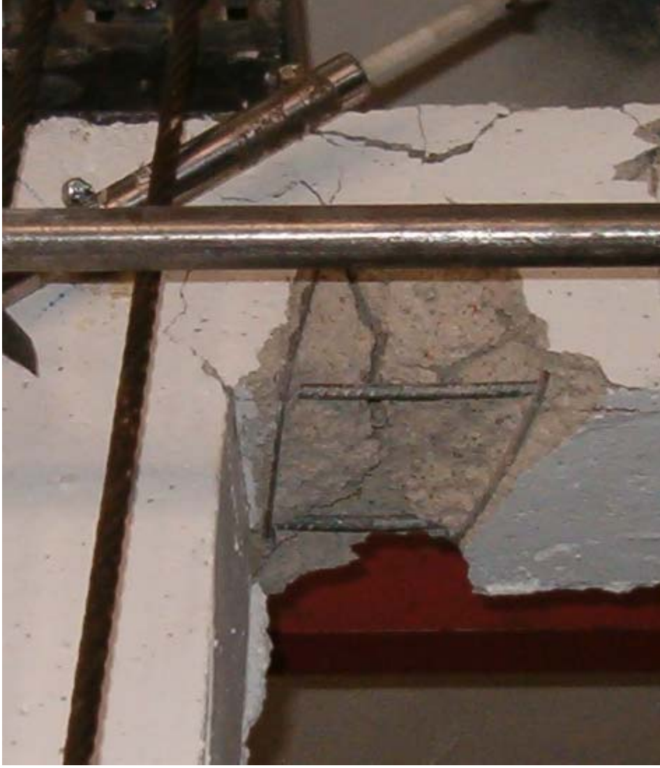
Şekil 5.9.11 Duvara saplanan üst kat kiriş ucunda hasar
