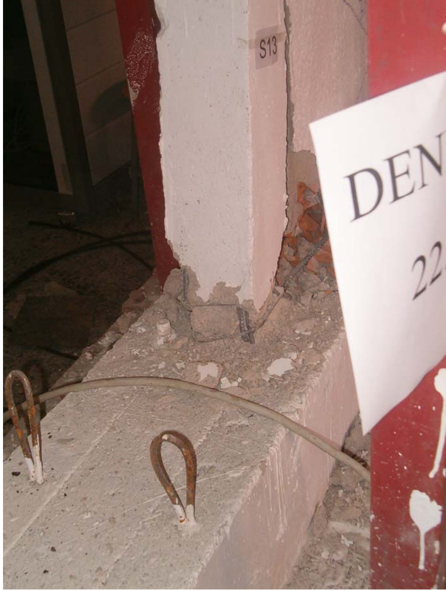
Şekil 5.10.7b Deney numunesinin kenar kolon altında belirgin hasar oluşumu
