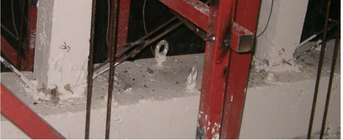
Şekil 5.7.12 Kolon tabanında ezilmeler
