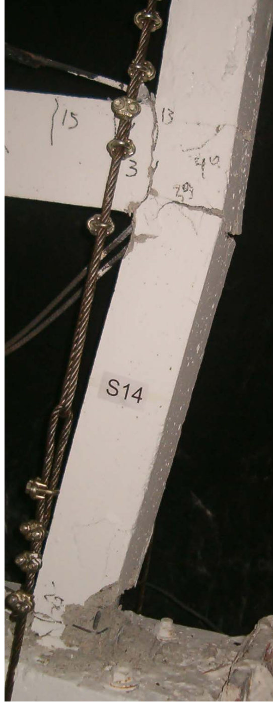
Şekil 5.7.7 7 nolu deney numunesinin kenar kolon altında belirgin hasar oluşumu
