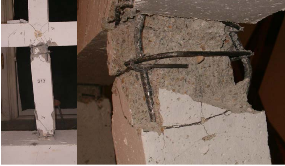
Şekil 5.2.6 2 nolu deney numunesinin orta kolon üstünde mafsallaşma , burkulma ve etriye çözülümü
