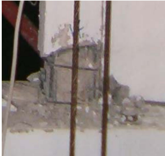
Şekil 5.9.9 Kolon altında ezilme
