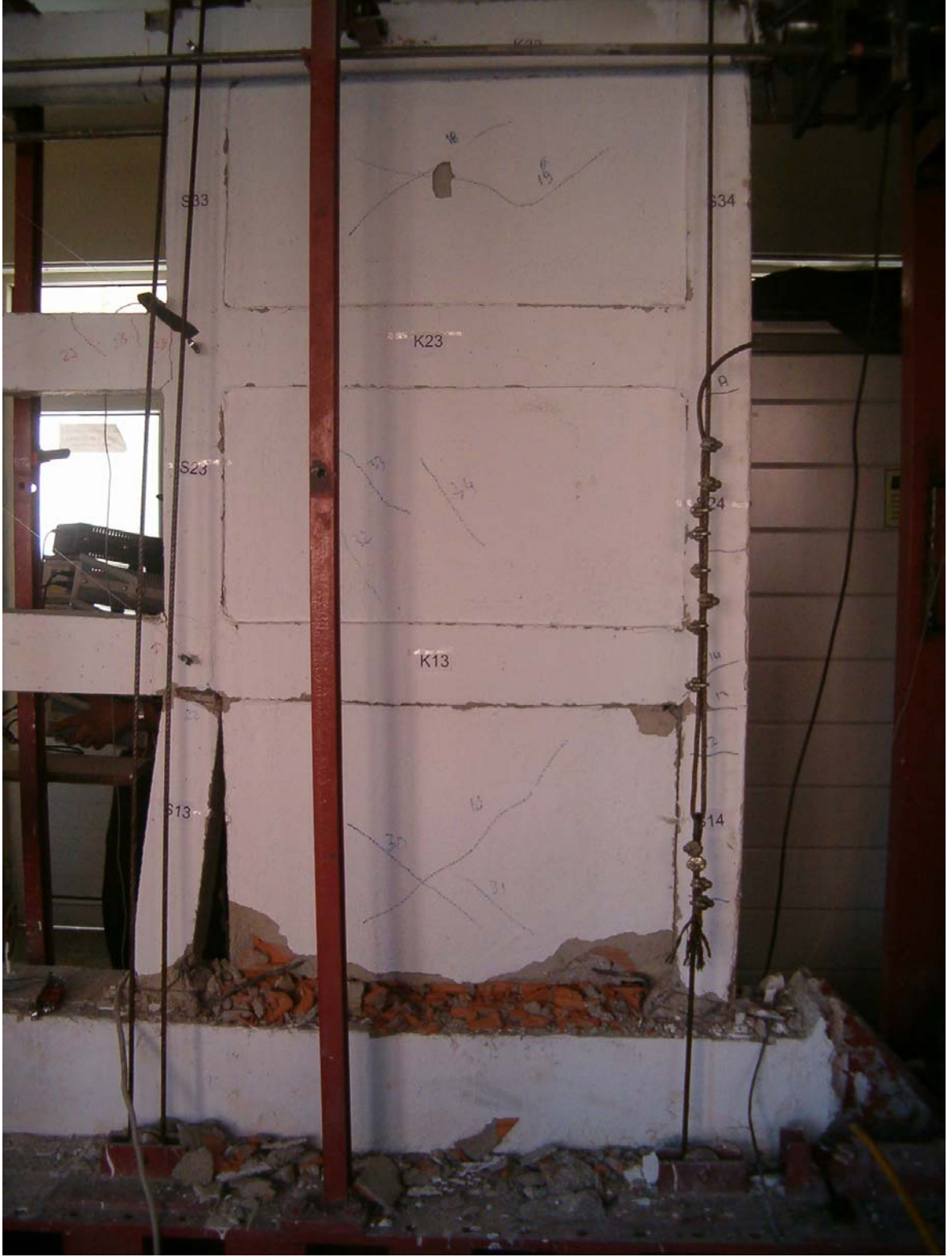
Şekil 5.10.8 Dolgu duvarda hasar oluşumu
