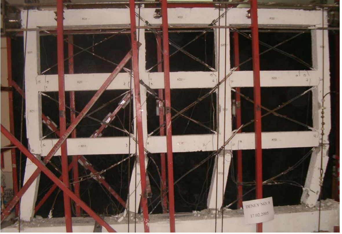
Şekil 5.8.9 8 nolu deney numunesinde yumuşak kat mekanizması
