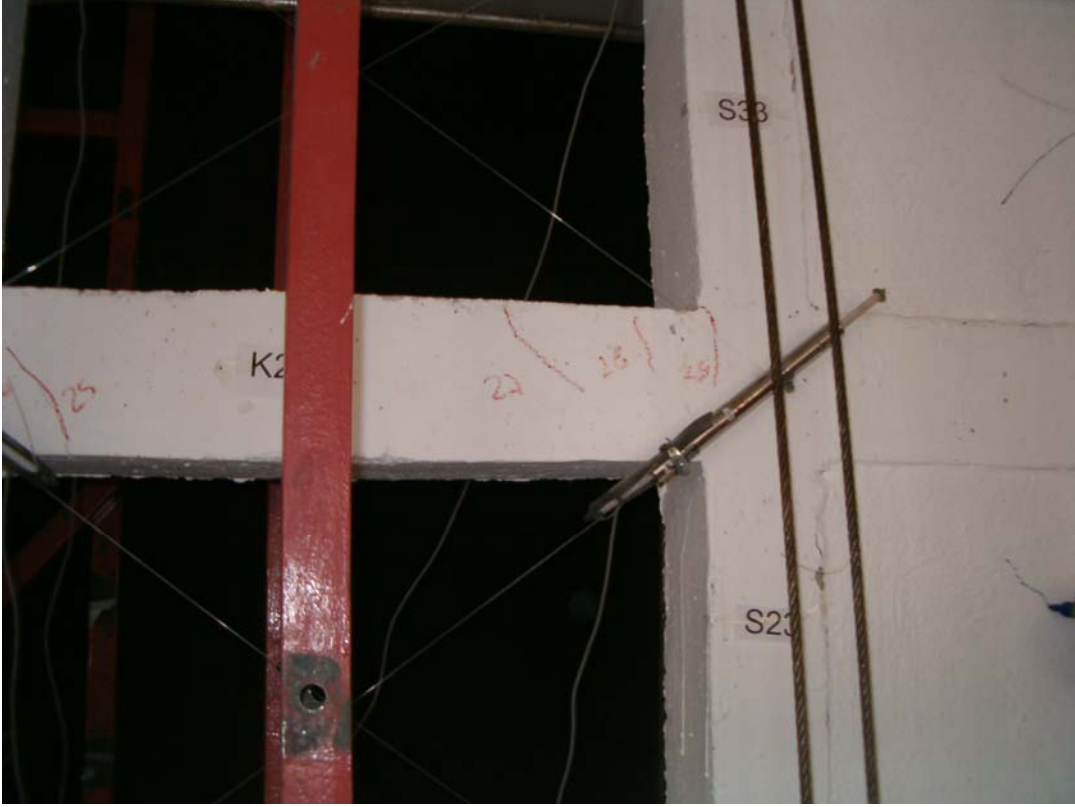
Şekil 5.10.5 Eğilme ve kesme hasarına uğrayan ara kat kirişi
