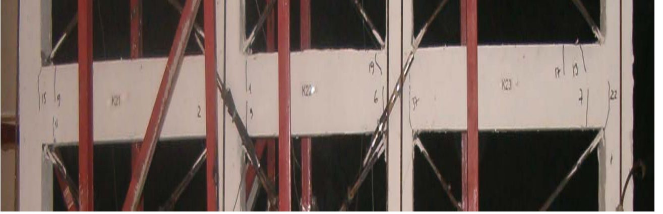
Şekil 5.8.11 8 nolu deney numunesinde 2.kat kirişlerinde hasar oluşumu
