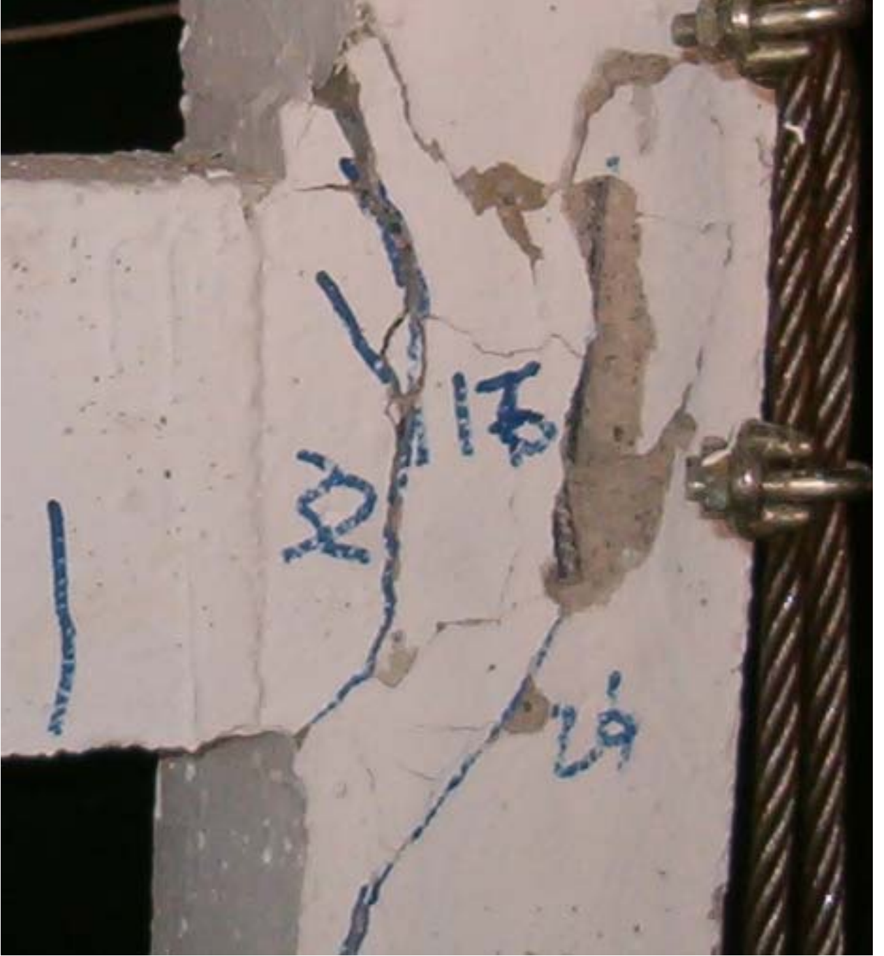
Şekil 5.9.10 9 nolu deney numunesinde ilk kat dış kolon kiriş birleşiminde hasar oluşumu
