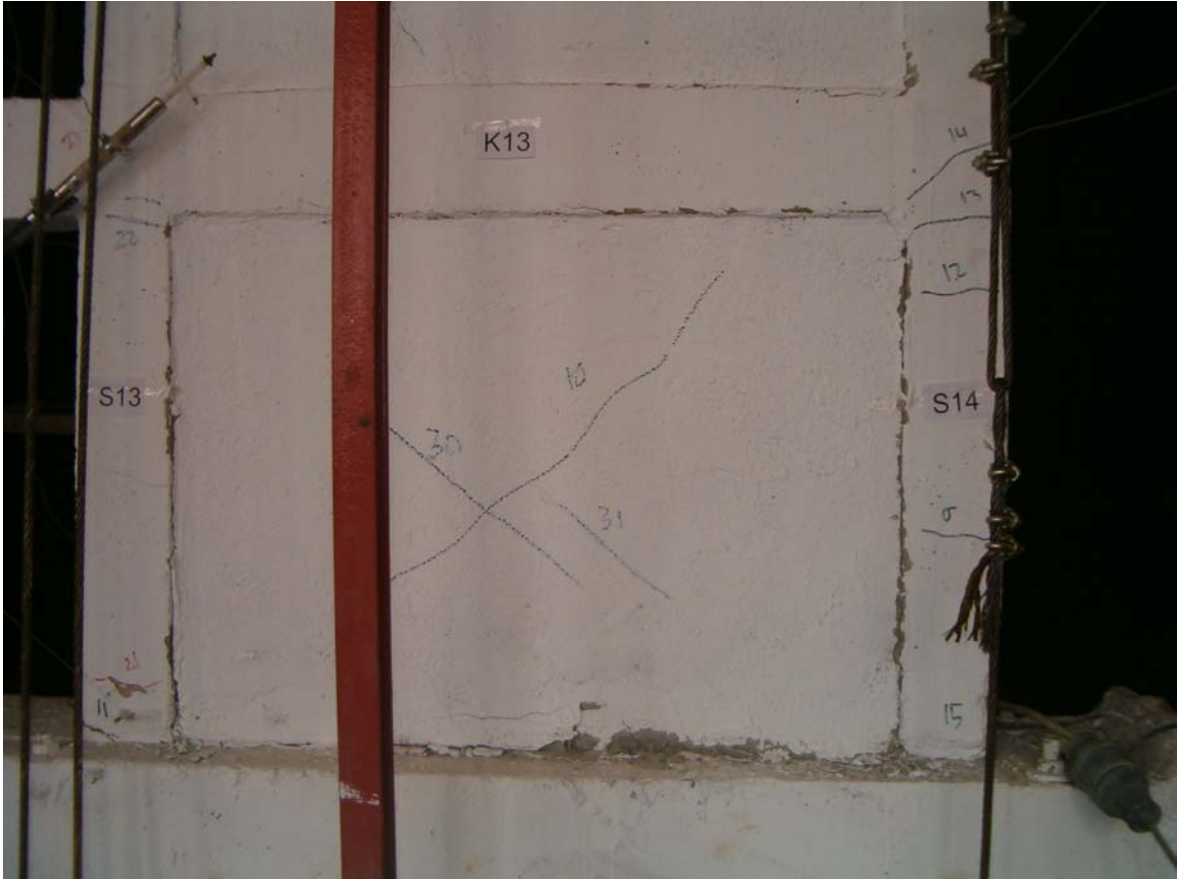
Şekil 5.10.6 Dolgu duvarda X çatlakları ve kolonlarda çekme çatlakları
