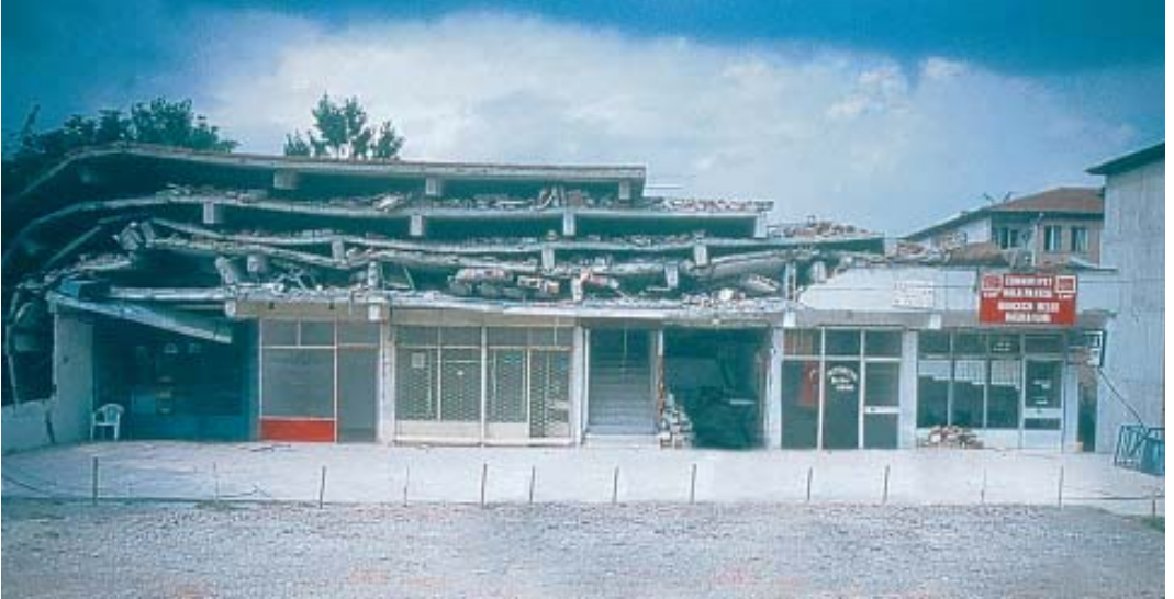
Şekil 1.6 Üst katlarda yumuşak kat davranışı (İzmit 1999)
