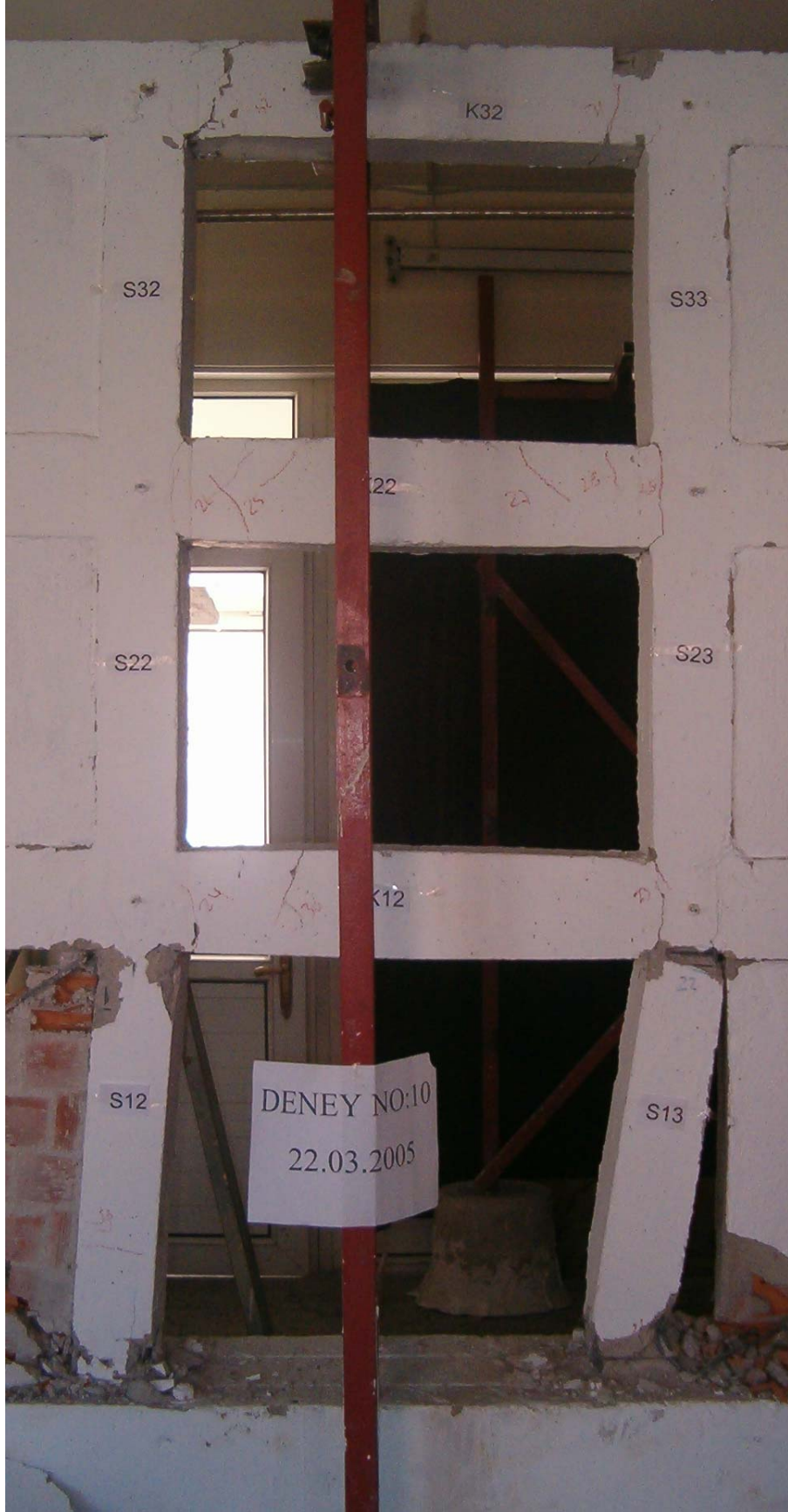
Şekil 5.10.10 10 nolu deney numunesinde orta kirişlerde hasar oluşumu
