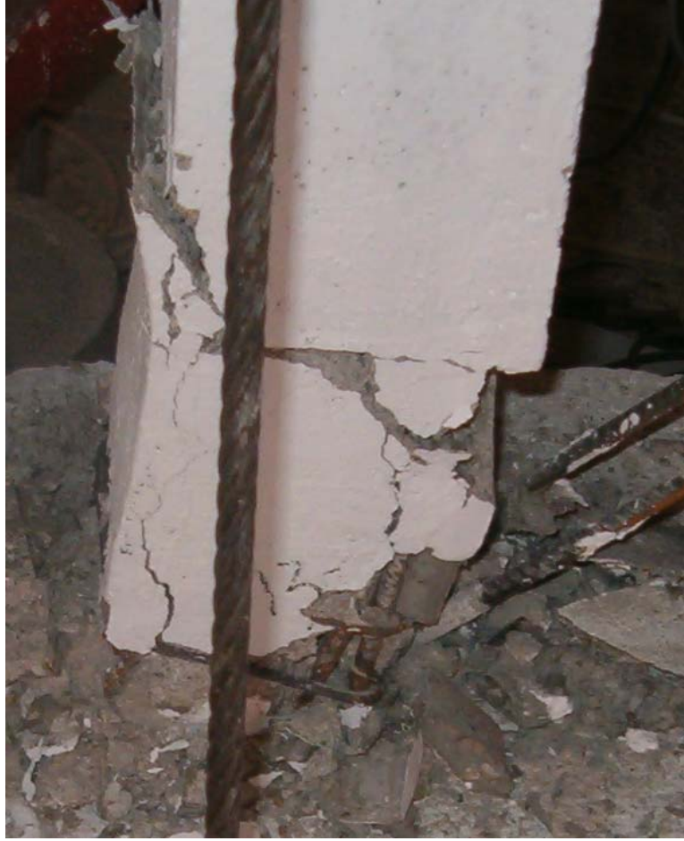
Şekil 5.6.7 6 nolu deney numunesinin kenar kolon altında belirgin hasar oluşumu
