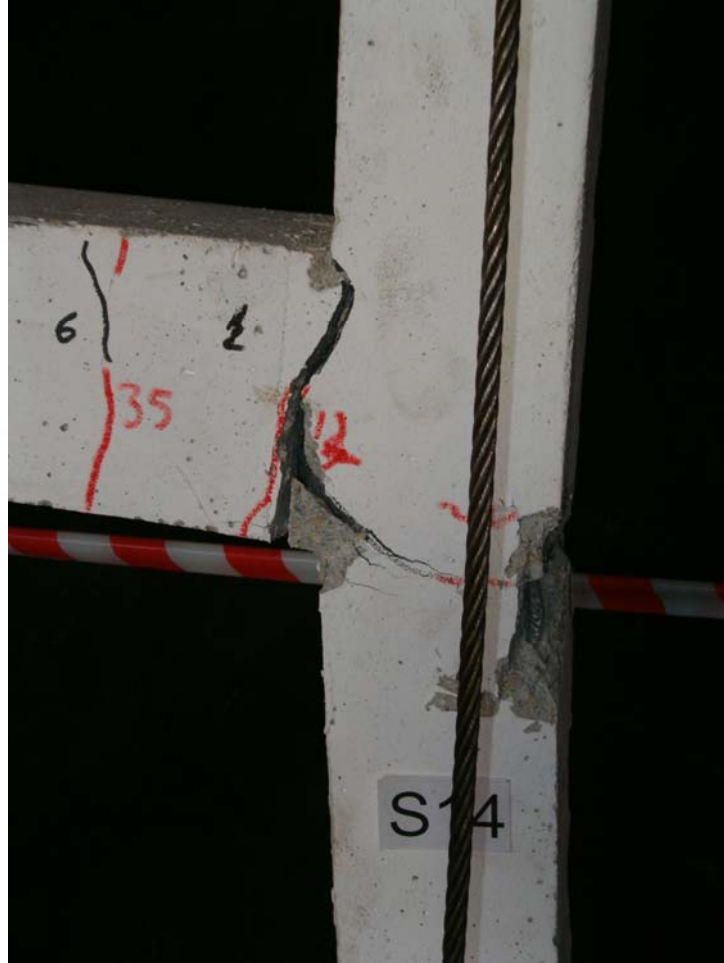
Şekil 5.1.7. 1 nolu deney numunesinin pilye kırım bölgesinde meydana gelen çatlama (6), kiriş ve kolon üst ucunda hasar, S14 kolon donatısında burkulma
