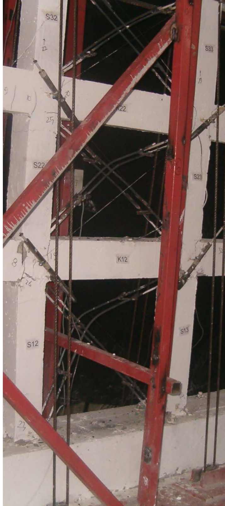
Şekil 5.5.9. 5 nolu deney numunesinde çalışan kuşaklamalar
