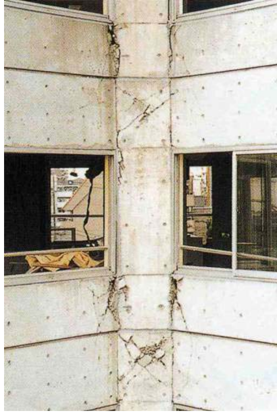
Şekil 1.11 Güçlü kiriş zayıf kolon sonucu oluşan hasar mekanizması
