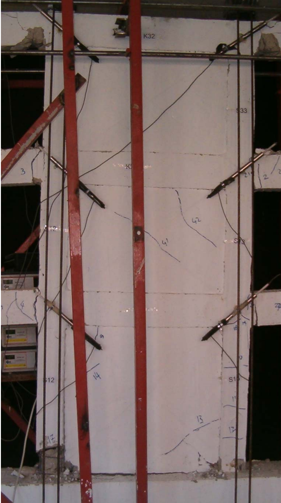
Şekil 5.9.6 Orta açıklıkta bulunan dolgu duvarda hasar oluşumu
