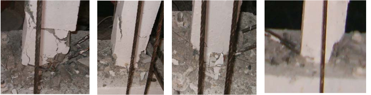
Şekil 5.6.12 Kolon tabanında ezilmeler
