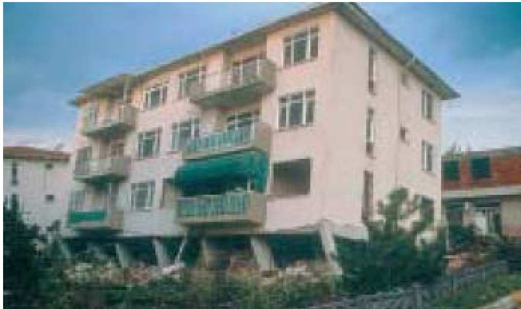
Şekil 1.2 Yumuşak kat mekanizması sonucu yıkılmış bina (İzmit 1999)
