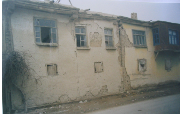
Şekil 3.41 Bitişik nizam yapılarda çarpma hasarı (Akşehir-2002 Sultandağı depremi)
