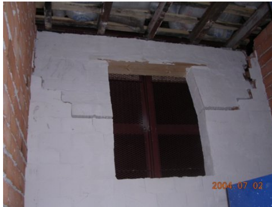
Şekil 4.36 Yatay yüke dik duvarlarda meydana gelen hasar (Kaynak: A.Türer)
