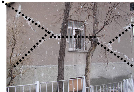
Şekil 3.25 Yığma duvarda basamaklı çatlak (2004-Erzurum, Kaynak: A. Türer)
