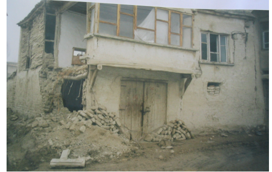
d) Duvarın düzlem dışı devrilmesi
