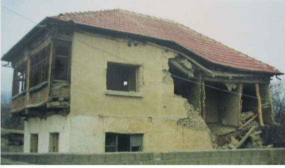
a) Düzlem dışı devrilen duvar ile döşemenin çökmesi
