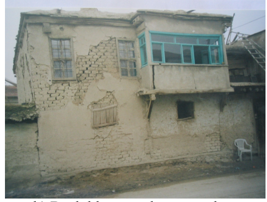
b) Boşluklar arası kesme çatlağı
