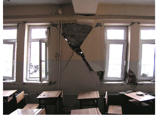
c) İçten kesme çatlağı
