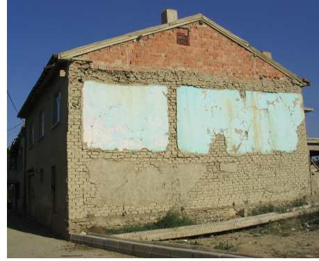
b) (Akşehir-2002 Sultandağı depremi)
