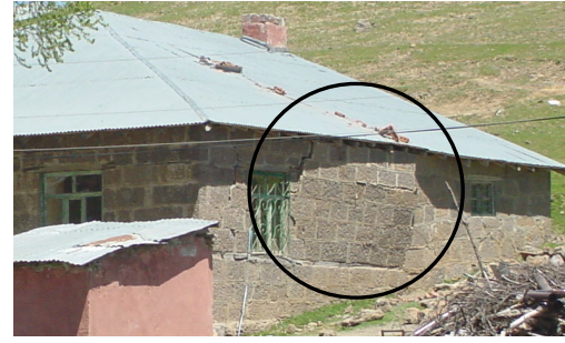
b) Yıkılmamış fakat hasar görmüş duvar
