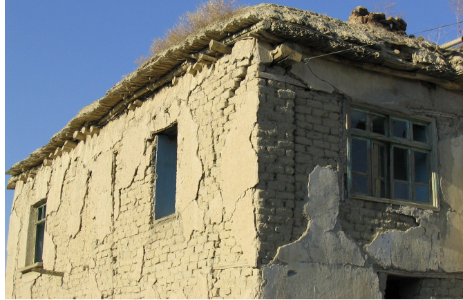
c) Kerpiç yapı (Akşehir-2002 Sultandağı depremi) Şekil 3.31 Yığma yapılarda köşe hasarı
