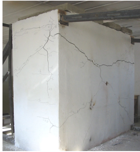
Deney sonrası çatlak durumu
