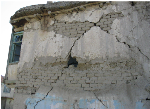
Şekil 3.20 Kerpiç yığma duvarda X çatlağı (Sultandağı 2002 depremi-Akşehir)
