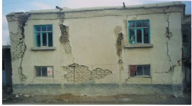
b) Kerpiç yapı (Akşehir-2002 Sultandağı depremi)
