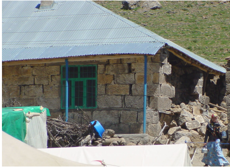
a) Tamamı yıkılmış duvar
