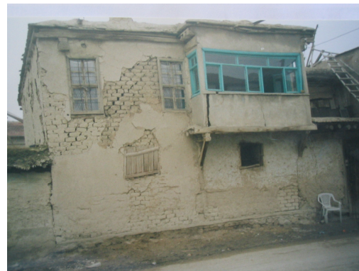
Şekil 3.21 Düşük harç dayanımı sonucu çatlak oluşumu, derzleri takip etmesi (Sultandağı 2002 depremi-Akşehir)
