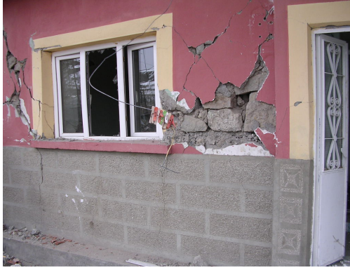
b) Dışarıdan kesme çatlağı
