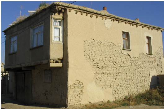
Şekil 3.76 Duvar yüksekliği boyunca hatıl bulundurmeyen kerpiç yapı
