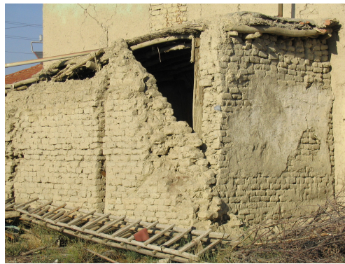
Şekil 3.34 Dik duvarlar arası zayıf bağlantı (Akşehir-2002 Sultandağı depremi)
