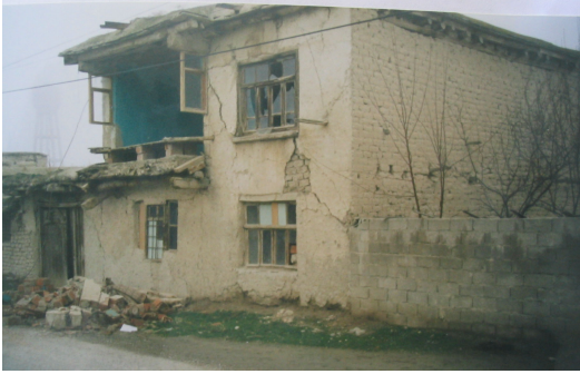
c) Duvarın düzlem dışı devrilmesi
