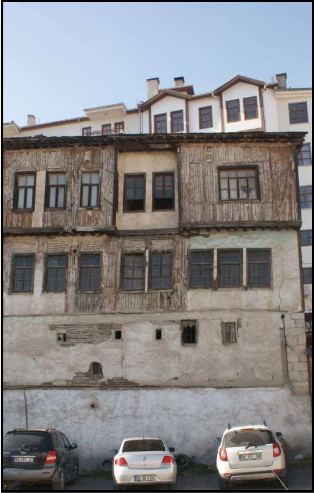
Şekil 5.21 Beypazarı evi (giriş kat: taş malzeme, 1. kat: ahşap malzeme ve dolgu malzemesi, 3. kat: ahşap malzeme) (Orjinal 2013)
