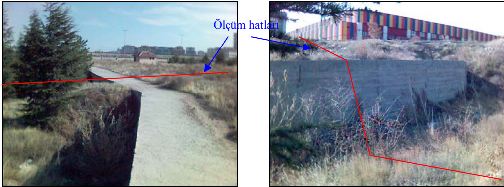
Şekil 4.2. Selçuk Üniversitesi, Alaeddin Keykubat Kampüsü içinde yeraltında bulunan fakat kampus kapısı civarında yüzeyleyen beton kanalizasyon kanalları.
