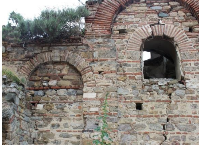
Resim 138. Kemerli Kilise, Güney Cephe, Kör Kemer, Almalı Teknik (Yinsel, 2016).
