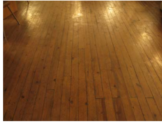
Resim 155- Seminer Odası Döşeme Kaplaması
