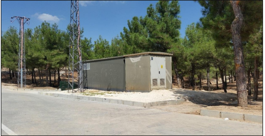
Şekil 4.36 Elektrik trafosu (Orjinal 2014)
