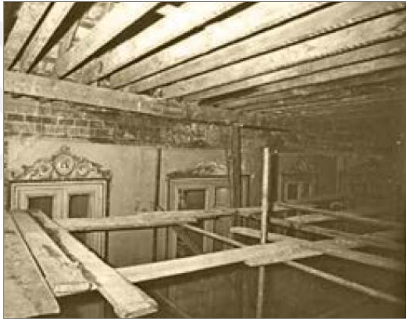
Şekil 4.36- 4 no.lu (salon) oda (1981 yılında yapılan onarımlardan) (TBMM MSFA)
