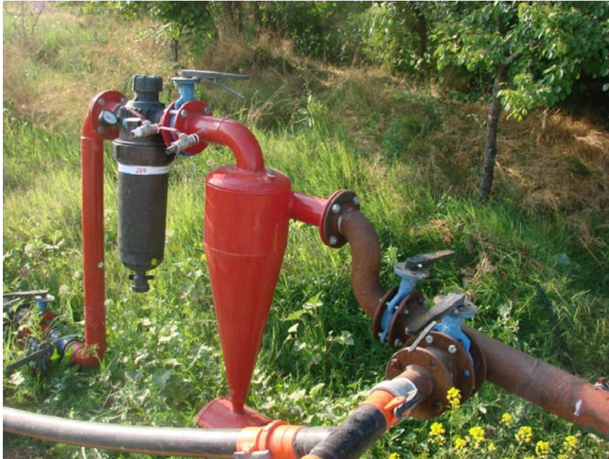
Şekil 3.4. Damla sulama sistemine ait kontrol ünitesi
