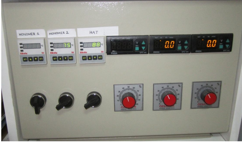
Şekil 3.11. Sıcaklık kontrol sistemi ekipmanları
