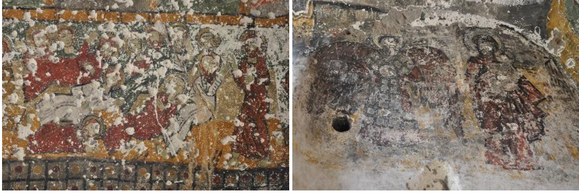
Resim 172. Eğri Taş Kilisesi, tonoz kuzey yarısı Resim 173. Eğri Taş Kilisesi, Mekan 2, doğu duvar Mekan 2'nin doğu duvarında eksenin kuzeyinde baş melek Mikhael (a), güneyinde Meryem (C); güney duvarda eksenin doğusunda İsa (D) ekseninde tanımlanamayan iki figür (520); eksenin batısında üç figür ve bir melek tasviri yer alır (i) (Resim 173-174) (Çizim 52).
